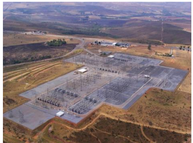
Figura 2- Subestação de potência [1].
