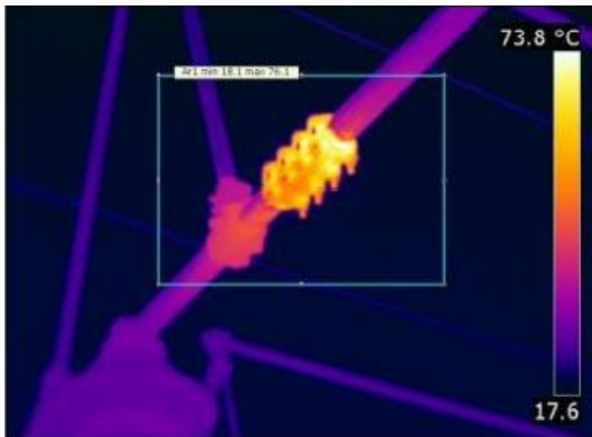
Figura 4-Termograma de uma conexão de barramento [9].
