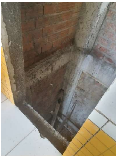
Figura 5 - Acesso vertical sem sinalização. Autoria própria.
