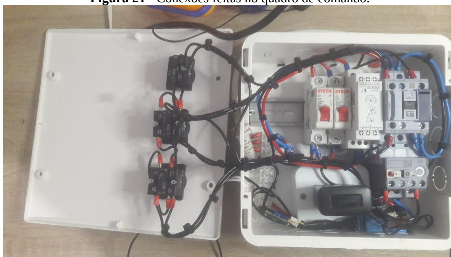
Figura 21 - Conexões feitas no quadro de comando.
