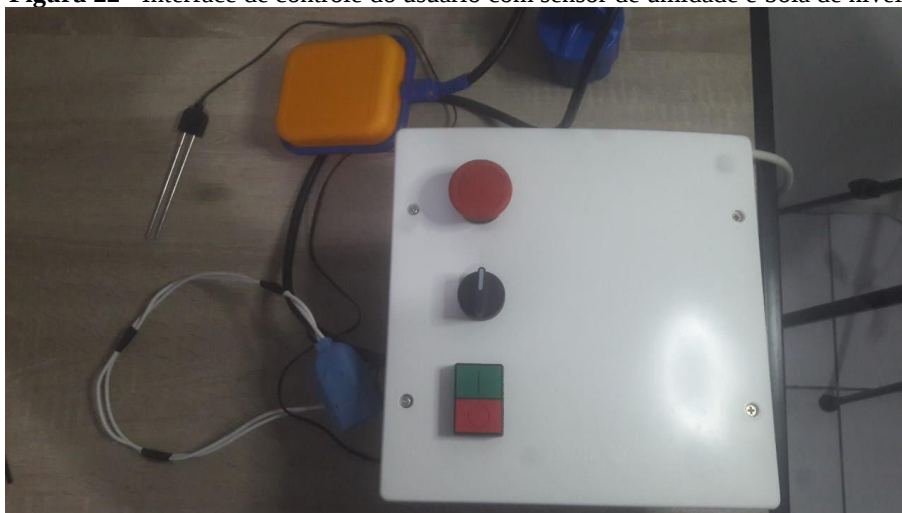
Figura 22 - Interface de controle do usuário com sensor de umidade e boia de nível.
