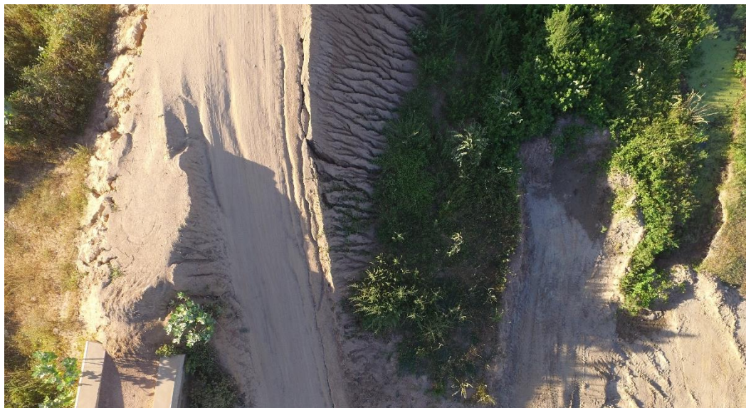
a) Afundamento observado no final da Barragem 2
