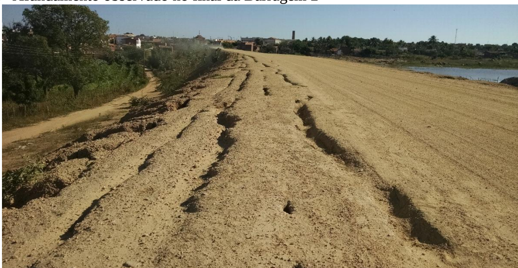
b) Sinais de deslizamento observados na Barragem 1
