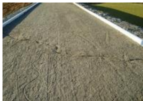
b) Rachadura transversal na crista da barragem Ipuzinho
