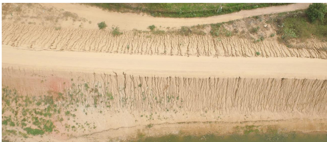
Figura 23 - Erosões na barragem 1
