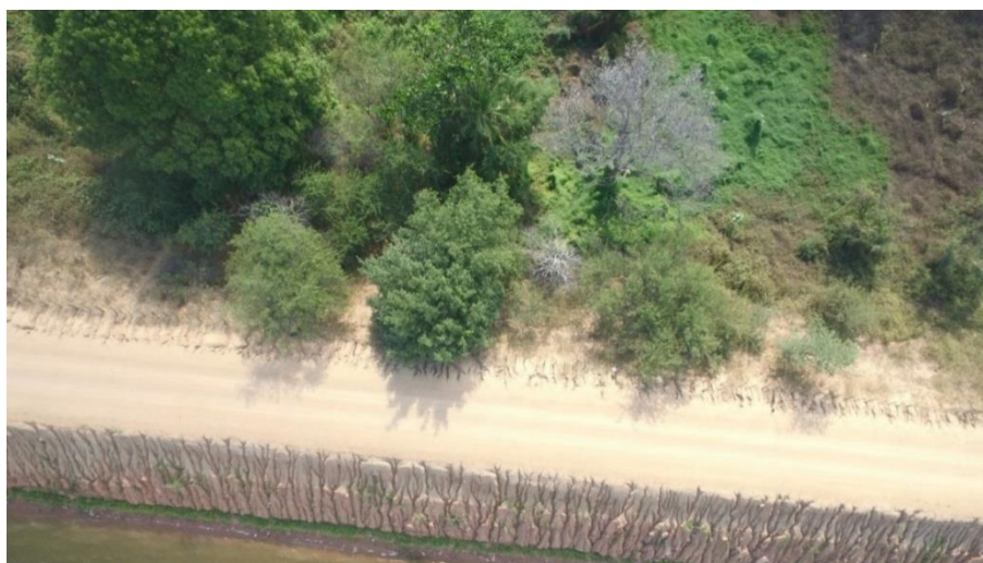
Figura 25 - Vegetação no talude de jusante Barragem 2
