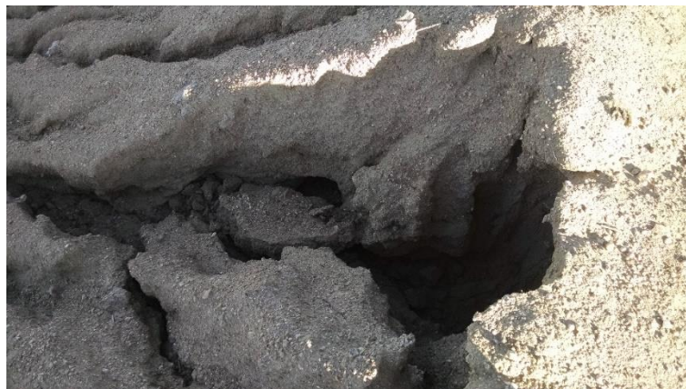
Figura 24 – Erosões na Barragem 2
