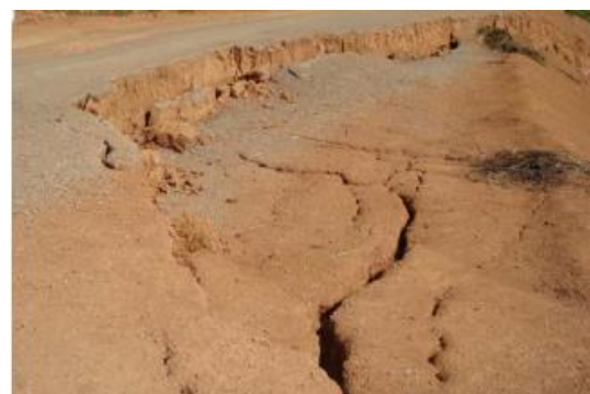
b) Deslizamento real da crista de uma barragem
