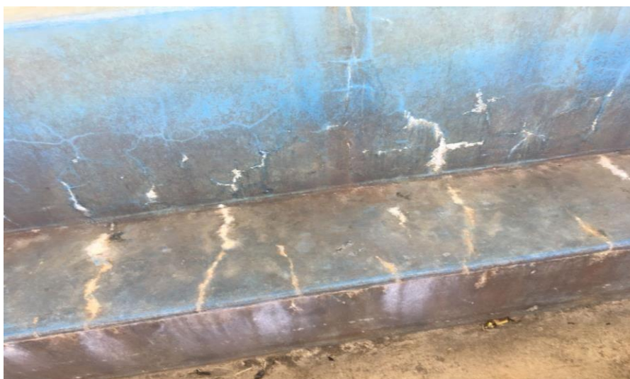
Figura 11 - Manchas de umidade no banco de reservas
