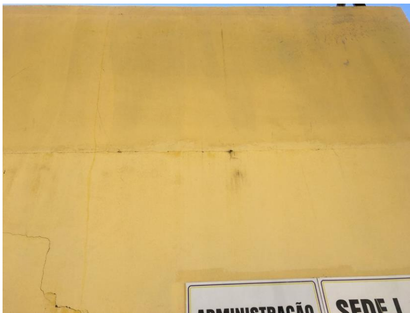
Figura 16 - Fissura no setor de entrada
