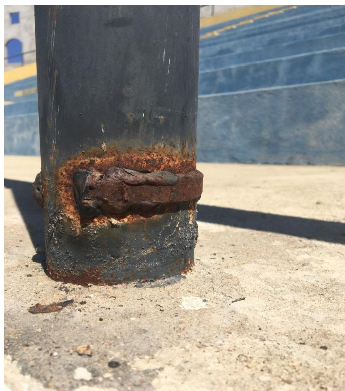
Figura 12 - Processo corrosivo no suporte de arquibancadas Fonte: Bessa. 2018
