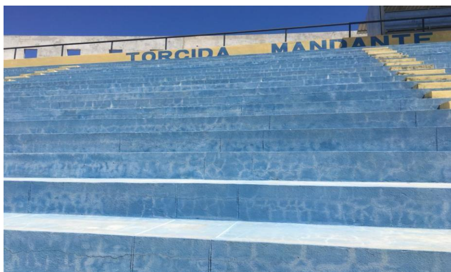
Figura 7 - Manchas brancas na arquibancada
