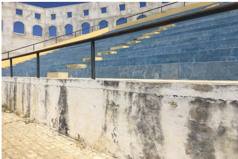
Figura 14 - Fissuras Horizontais na base da arquibancada
