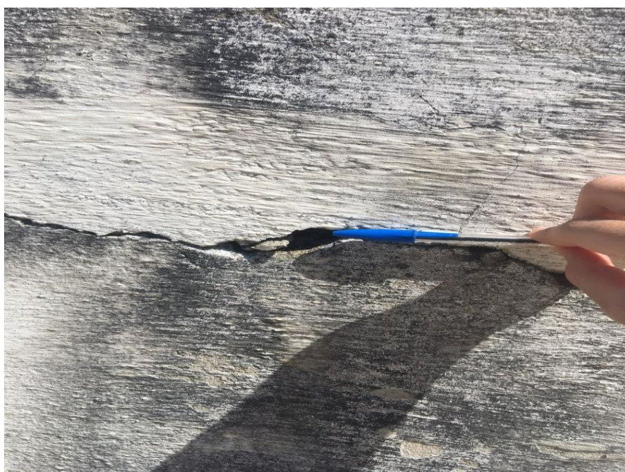
Figura 15 - Fissura horizontal, com objeto de escala
