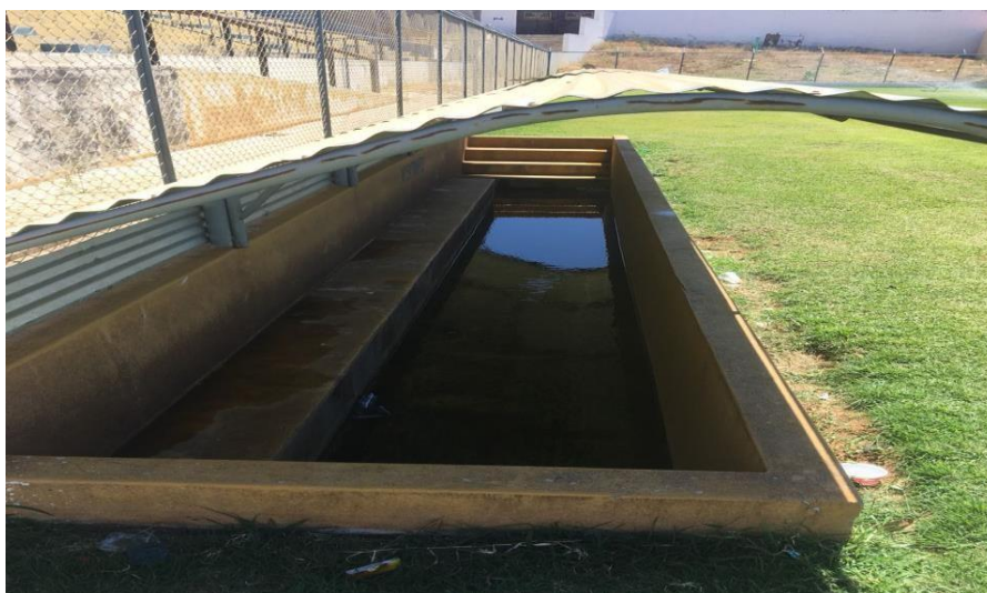
Figura 10- Acúmulo de água no banco de reservas
