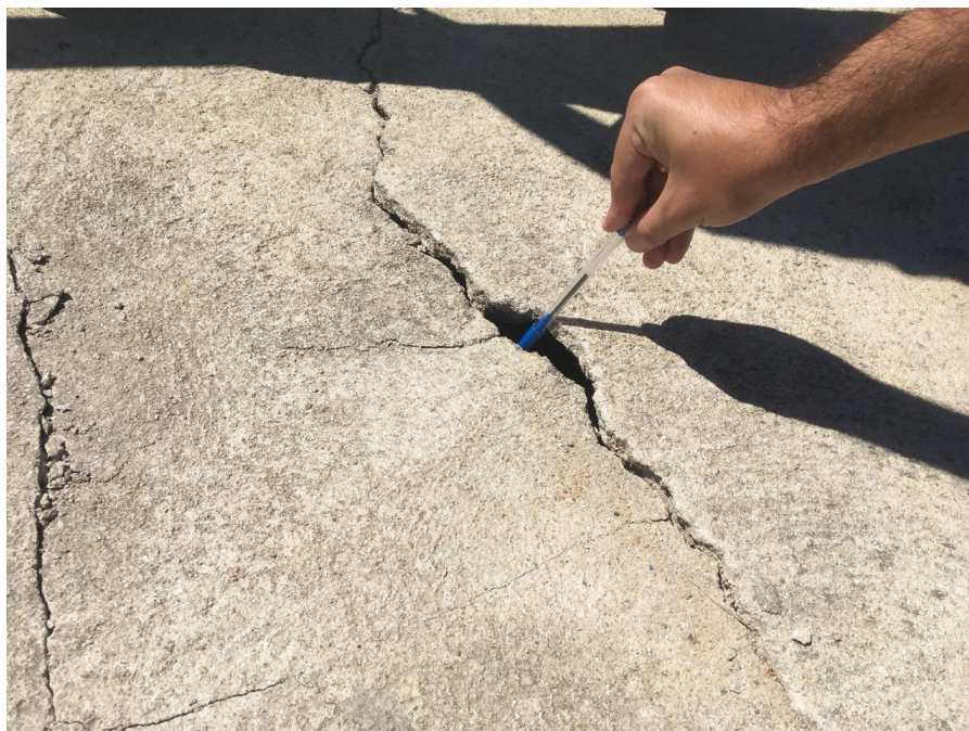
Figura 18 Fissura em estado crítico
