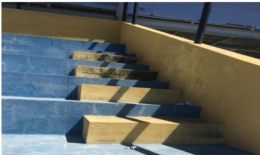
Figura 8 - Manchas pretas, ao lado da entrada no setor de espectadores.
