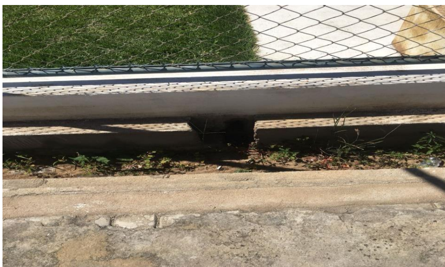
Figura 9 - Sistema improvisado e ineficiente de drenagem
