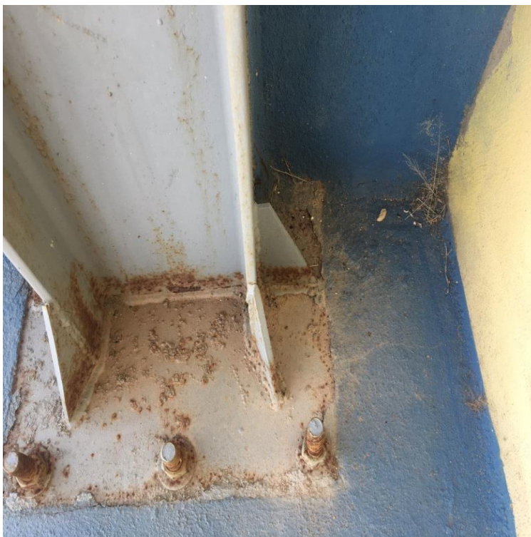
Figura 13 - Coluna de ferro em processo de Oxidação
