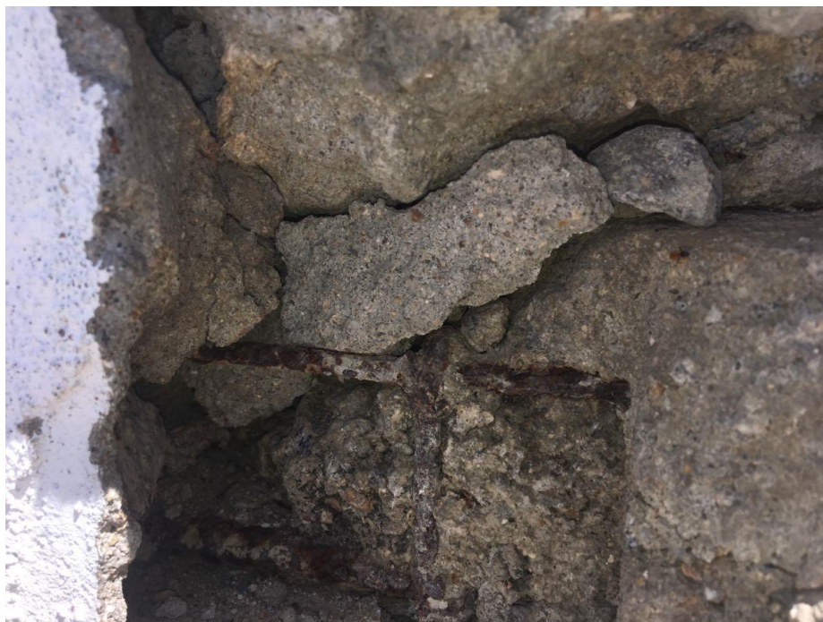
Figura 20 - Armadura exposta ao meio
