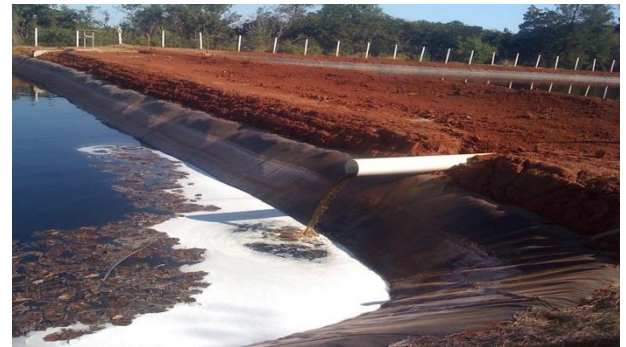
Figura 07: Tanque de tratamento de chorume.
