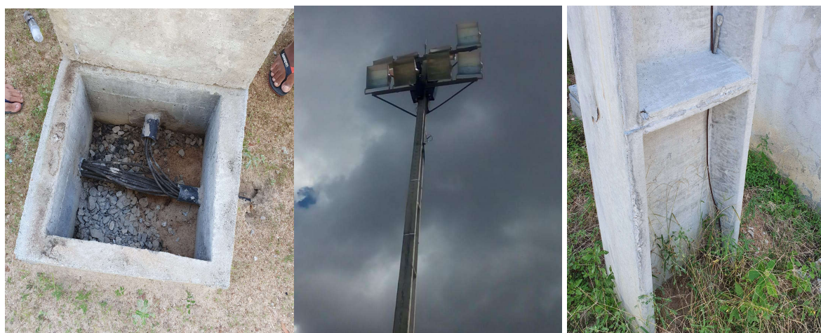
a) Caixa de Passagem do aterramento das torres b) Torre de iluminação c) Aterramento da Torre
