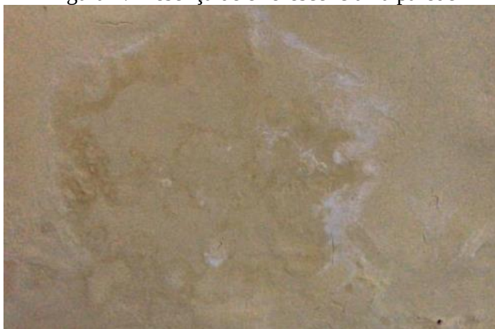
Figura 4: Presença de eflorescência na parede
