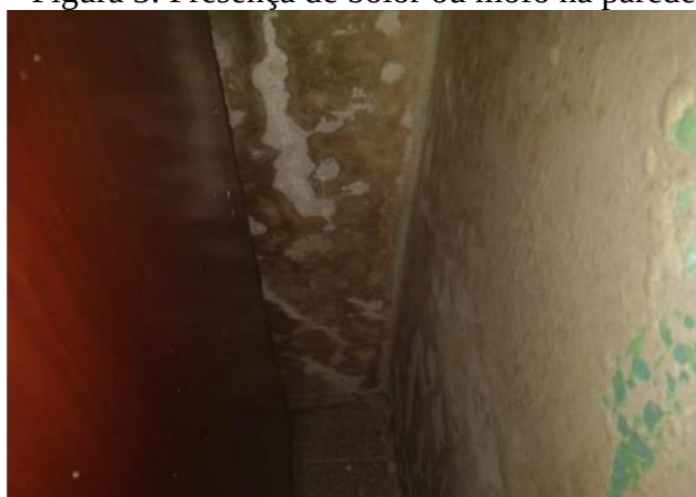
Figura 3: Presença de bolor ou mofo na parede
