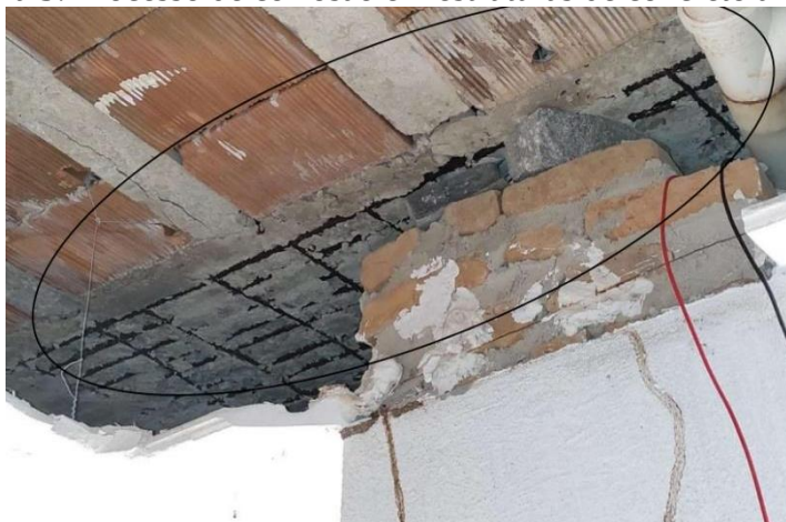
Figura 5: Processo de corrosão em estruturas de concreto armado
