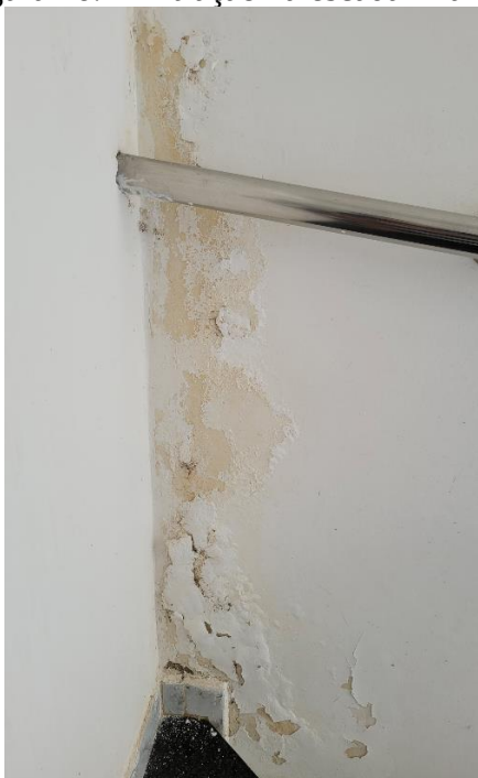
Figura 16: Infiltração na escada 1º andar
