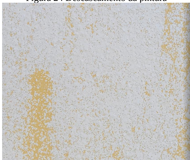
Figura 24 Descascamento da pintura
