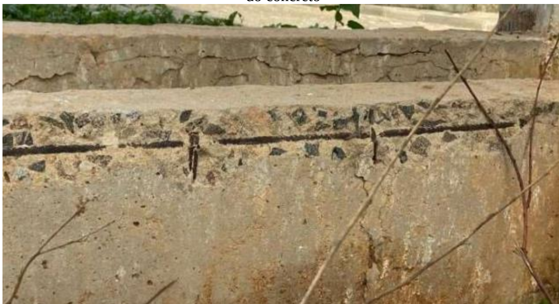
Figura 6: Desplacamento do cobrimento de concreto ocasionado pelo efeito da carbonatação do concreto
