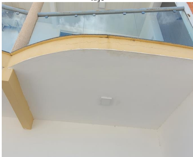
Figura 25: Fissura horizontal no revestimento da laje
