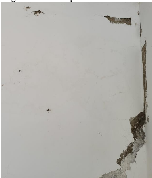
Figura 18: Infiltração na escada 2º andar
