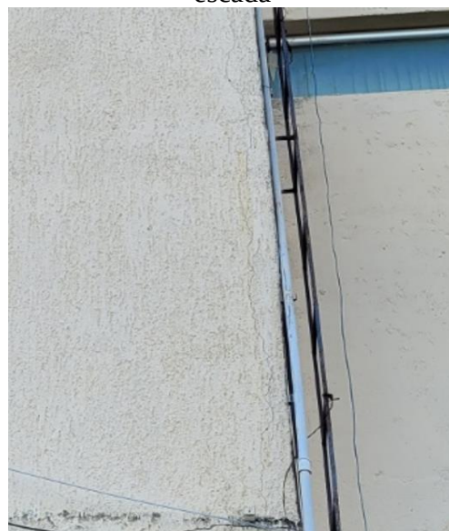
Figura 19: Fissura na parte externa da escada
