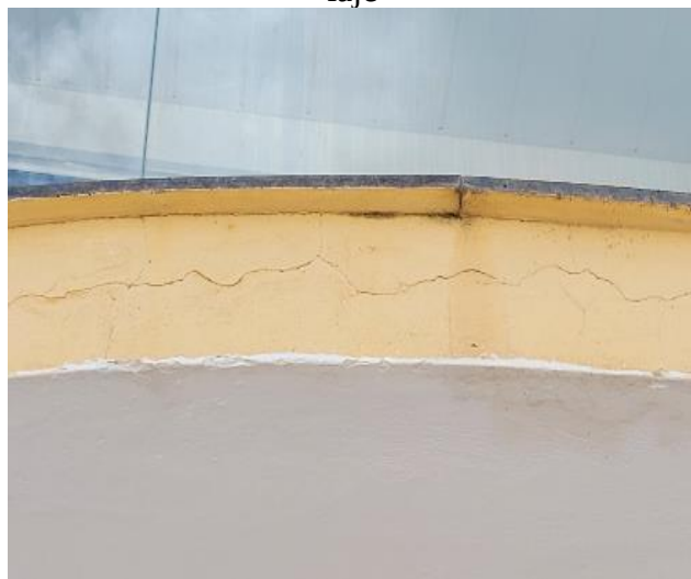
Figura 26: Fissura horizontal no revestimento da laje
