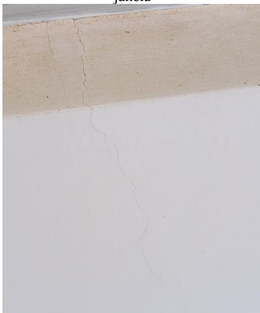
Figura 20: Fissura inclinada no peitoril da janela
