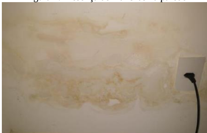
Figura 2: Presença de manchas na parede
