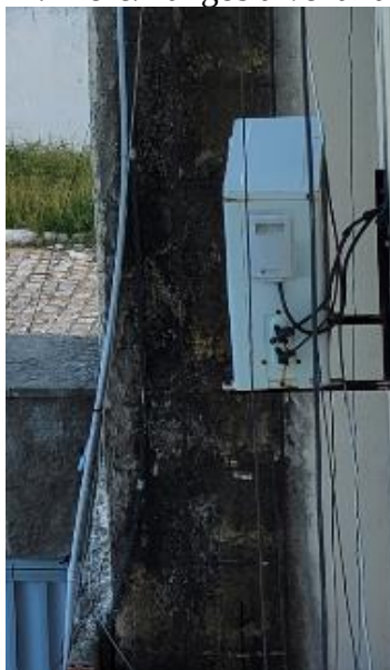
Figura 22: Mofo/ fungos alvenaria externa
