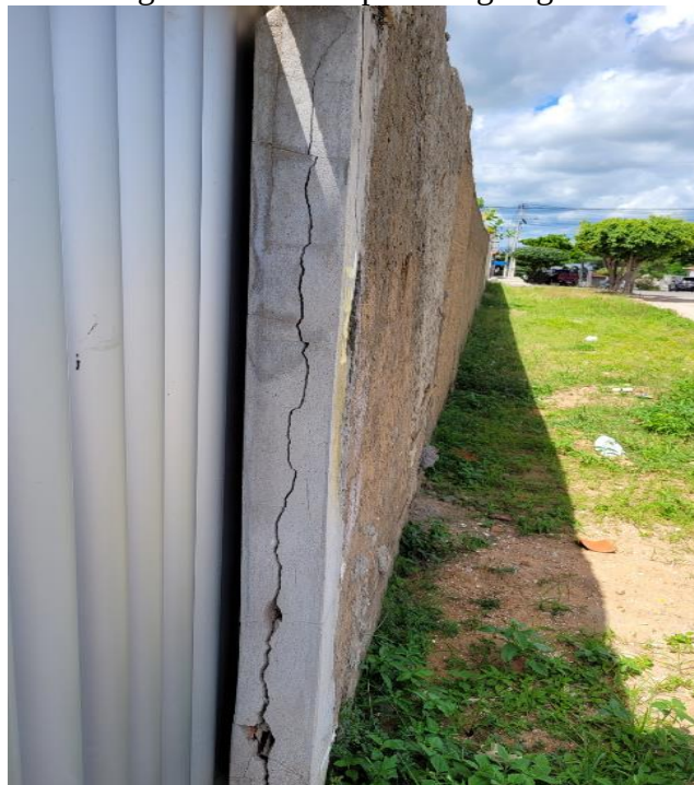
Figura 15 Fissura pilar da garagem
