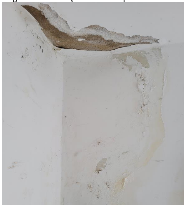
Figura 17: Infiltração na escada parede do térreo
