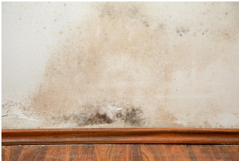
Figura 3: Manchas de mofo
