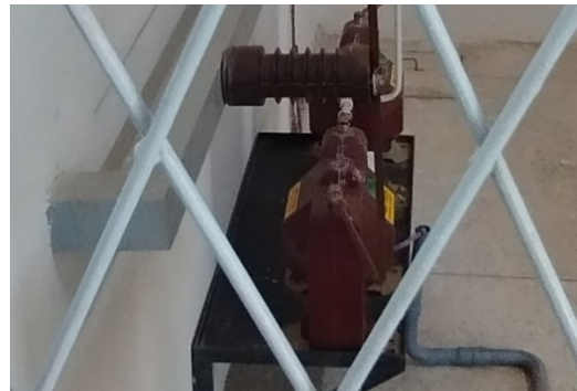
Fig. 11. Fotografia Transformadores de Potencial
