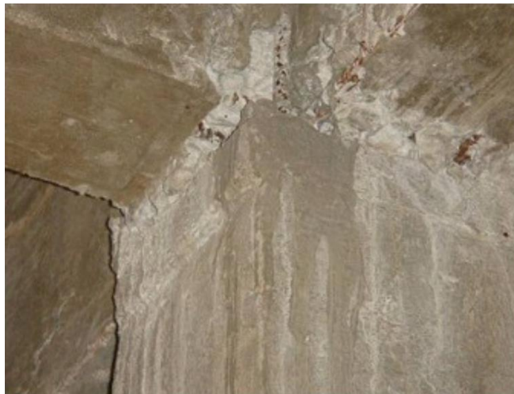
Figura 7: Segregação do concreto
