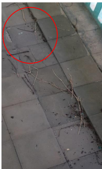
Figura 12: Deslocamento do piso
