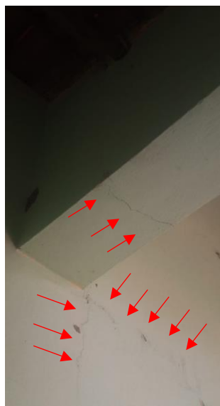
Figura 16: Fissuras em elementos estruturais
