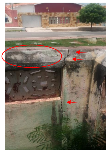
Figura 13: Manifestação patológica em parede externa
