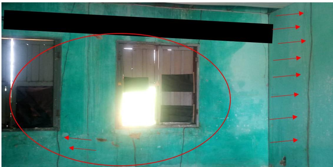
Figura 18: Umidade proveniente das chuvas
