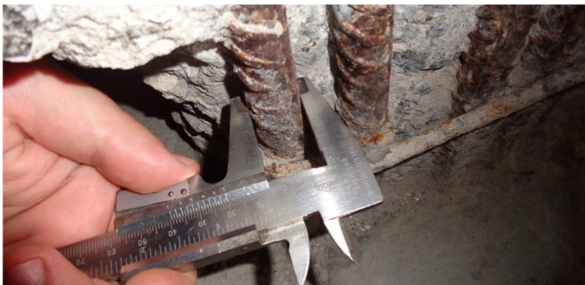
Figura 6: Corrosão das armaduras
