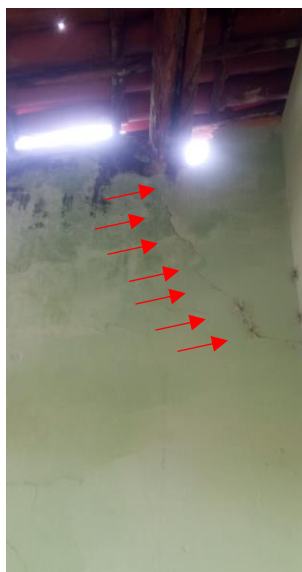
Figura 17: Fissura em elemento estrutural da cobertura
