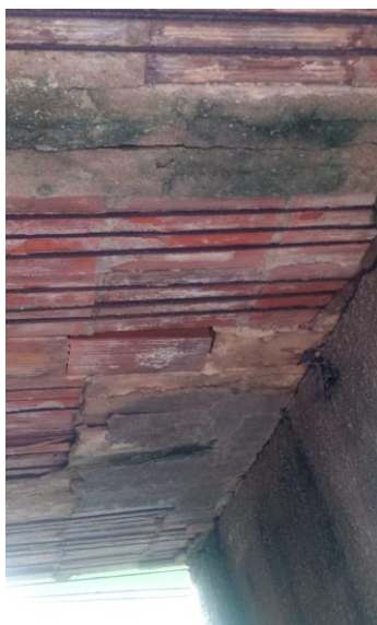
Figura 19: Corrosão da armadura e segregação do concreto
