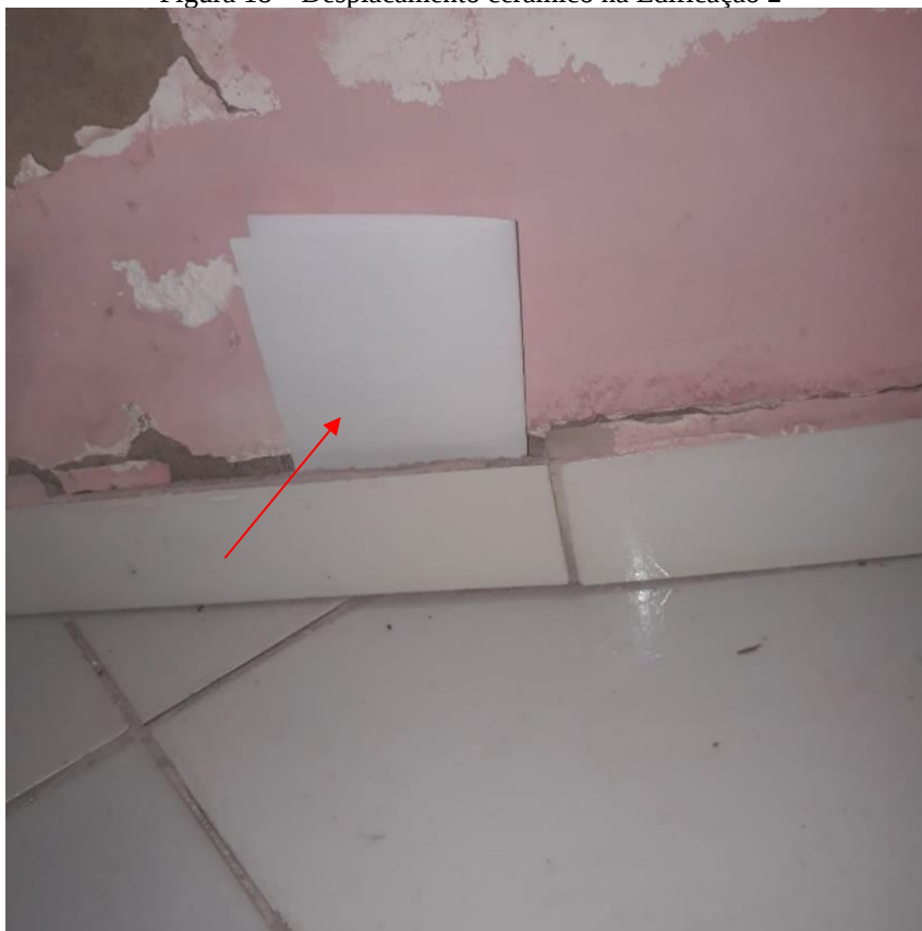
Figura 18 – Desplacamento cerâmico na Edificação 2
