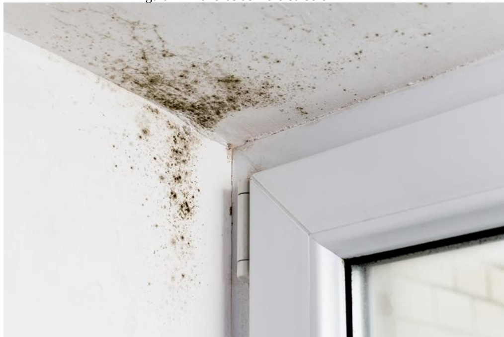
Figura 2– Manchas de mofo ou bolor
