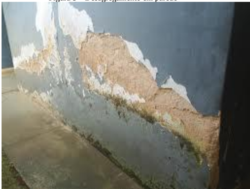
Figura 5 – Desagregamento em parede
