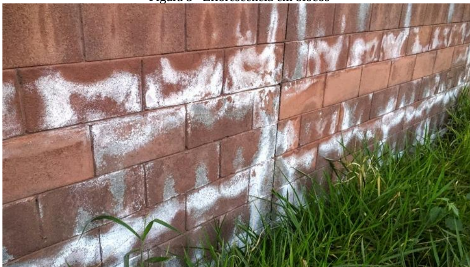
Figura 3– Eflorescência em blocos
