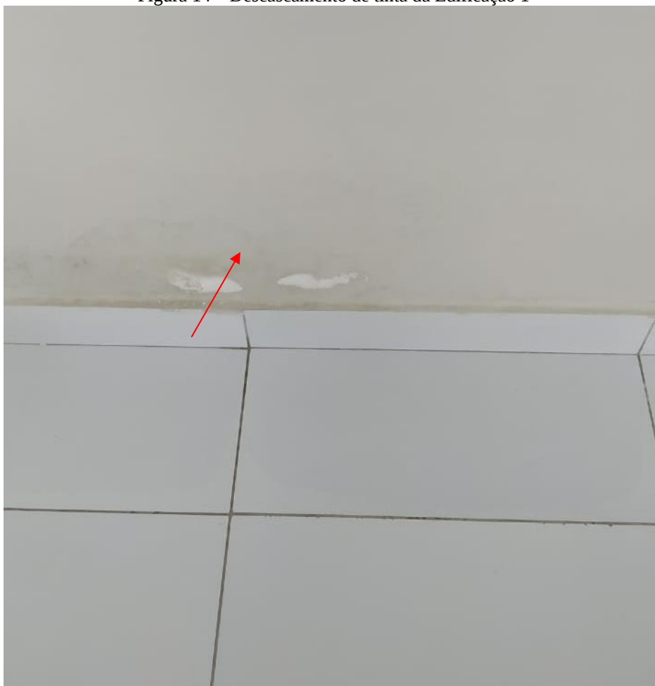
Figura 14 – Descascamento de tinta da Edificação 1
