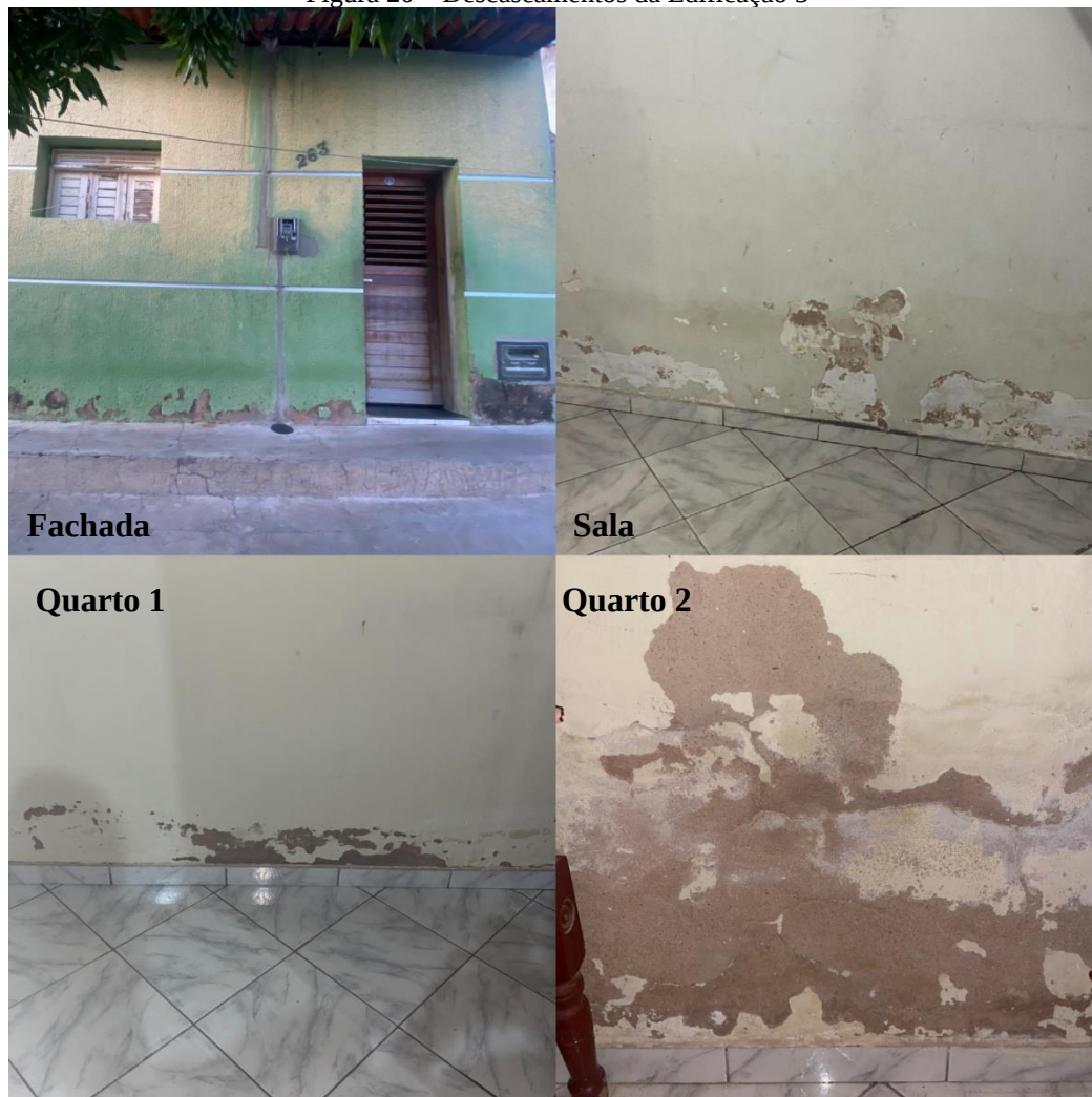
Figura 20 – Descascamentos da Edificação 3
