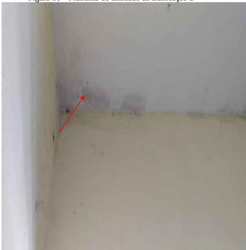
Figura 16 – Manchas de umidade da Edificação 2
