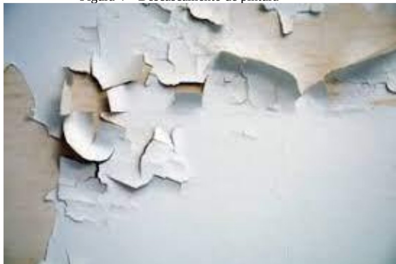
Figura 4 – Descascamento de pintura
