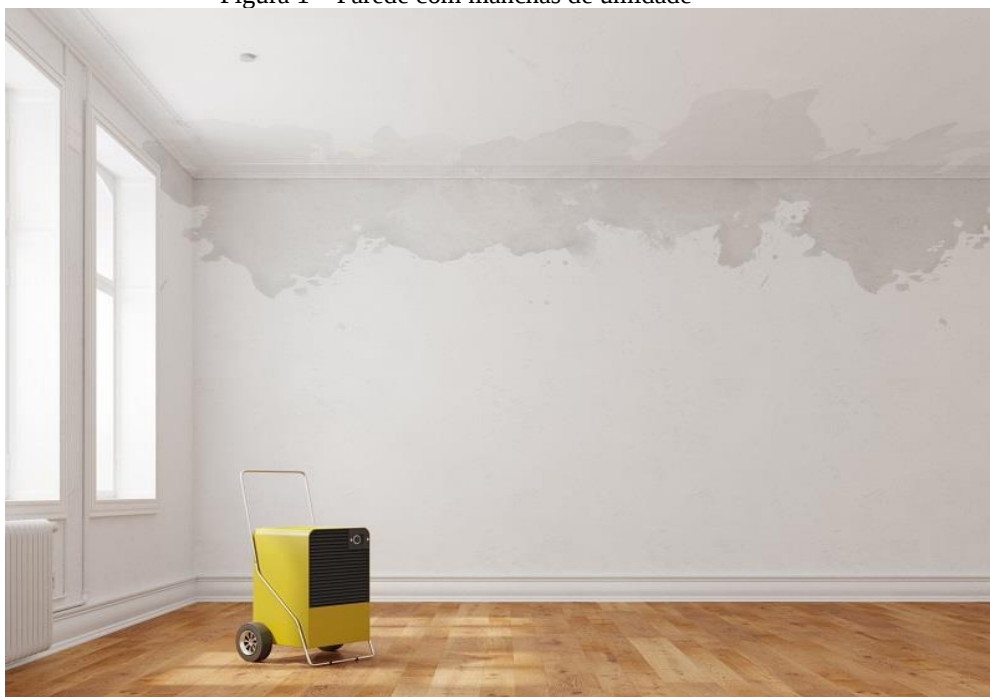
Figura 1 – Parede com manchas de umidade
