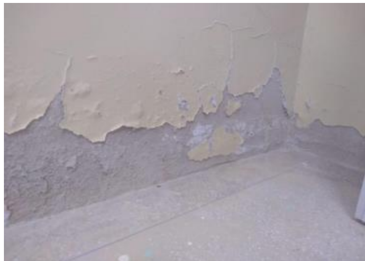
Figura 12: Descascamento de pintura
