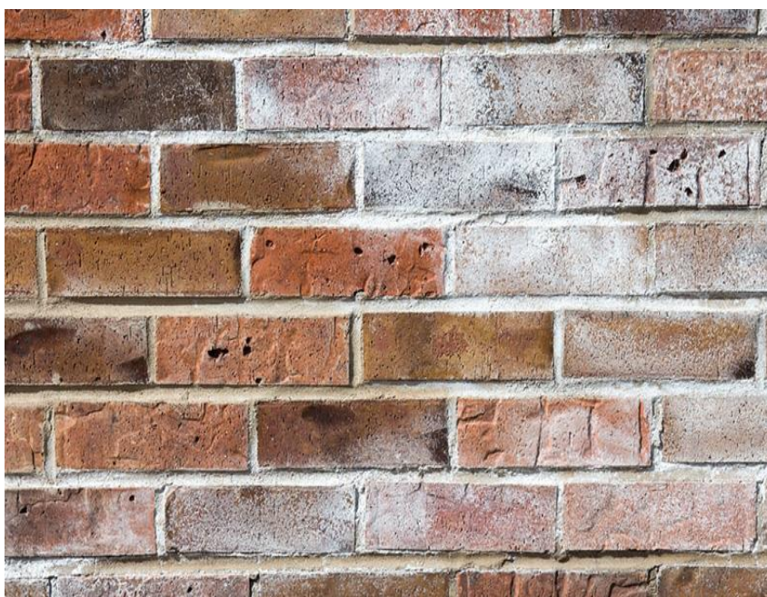
Figura 10: Presença de eflorescência em alvenaria cerâmica.
