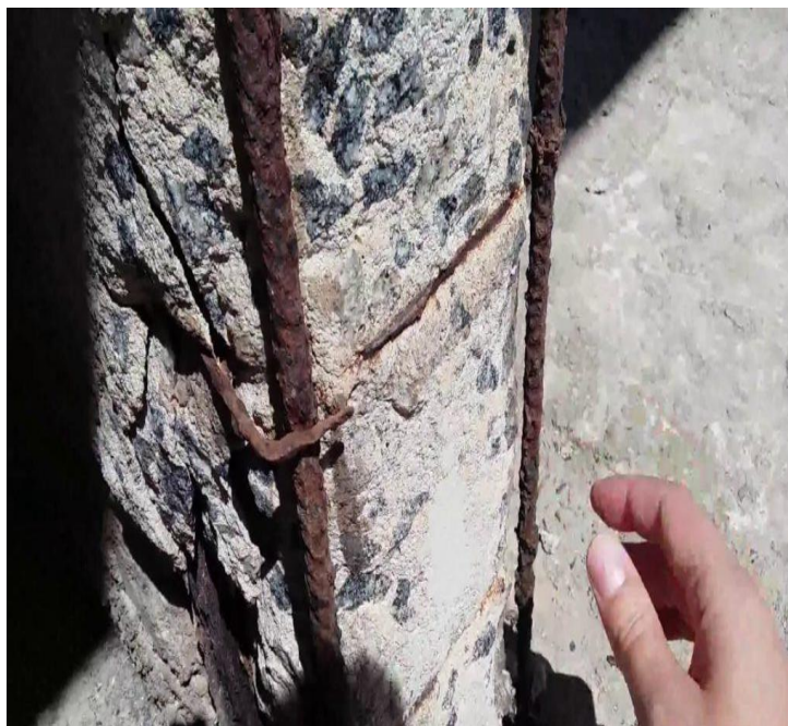
Figura 07: Corrosão da armadura
