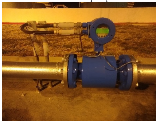
Figura 08, Medidor de vazão tipo Ultrassônico para líquidos instalado na ETO da empresa produtora.
