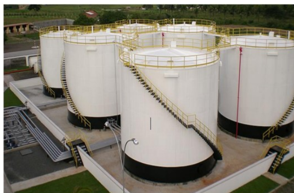
Figura 02 – Tanques de armazenamento de petróleo.
