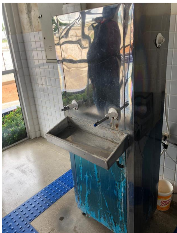
Figura 4 - Bebedouro da UFERSA – Campus Caraúbas
