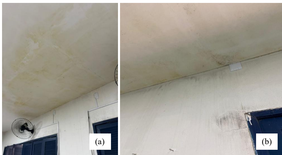
Figura 12 – Manchas de infiltração: (a) mancha amarelada no forro de gesso na sala da biblioteca; (b) detalhe da região afetada.
