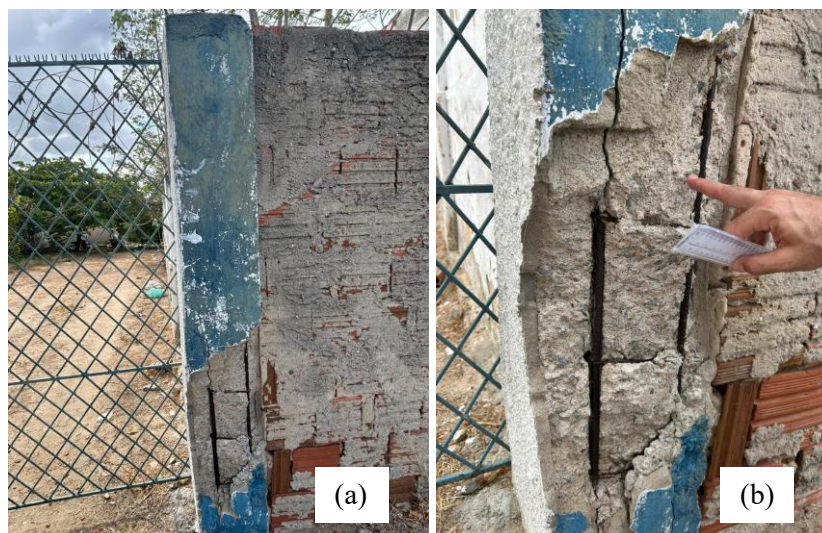
Figura 11 – (a) localização do pilar com corrosão na fachada frontal da escola; (b) – Detalhe da armadura exposta e com corrosão.
