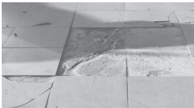
Figura 4 – Destacamento de placas cerâmicas
