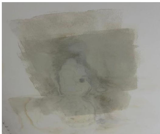
Figura 9 – Manchas de umidade decorrentes de infiltração na cobertura
