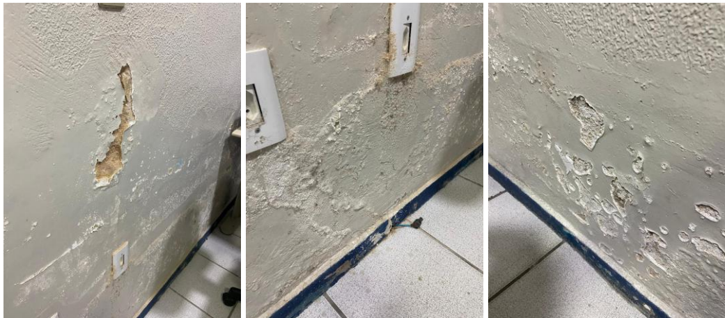
Figura 10 – Degradação do revestimento em razão de umidade ascendente por capilaridade.
