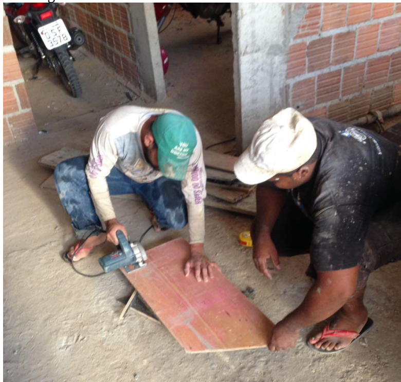
Figura 22 – Colaboradores trabalhando sem uso de EPIs
