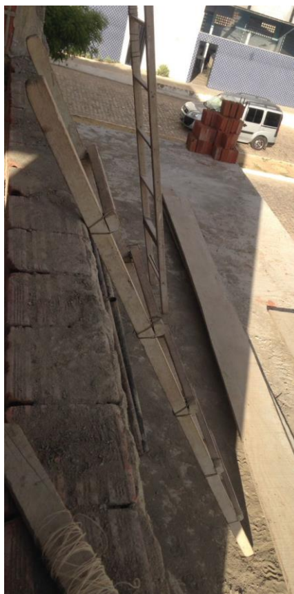
Figura 21 – Irregularidades na escada de mão
