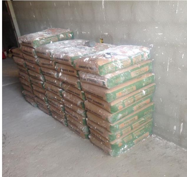
Figura 8 – Armazenamento de material dentro da casa
