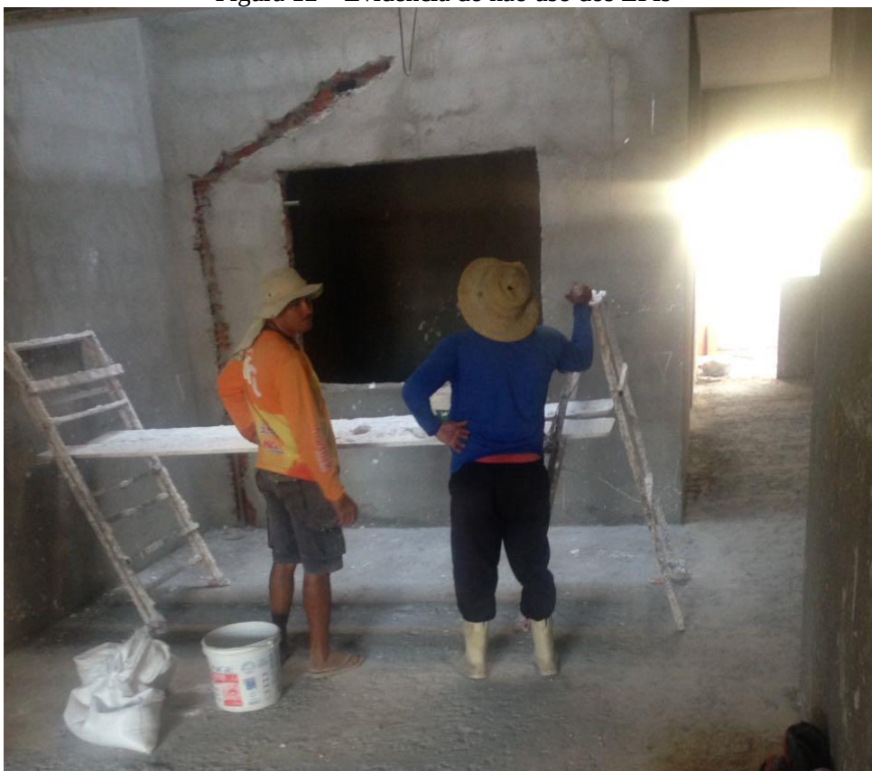
Figura 12 – Evidência do não uso dos EPIs
