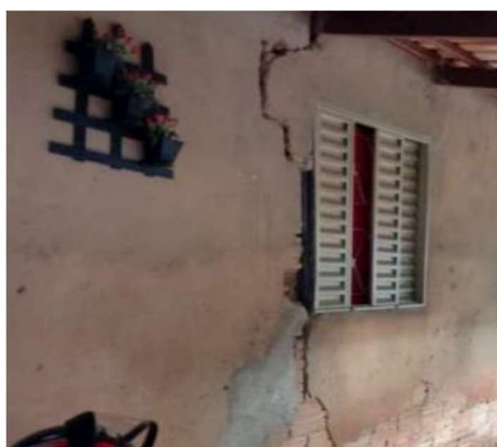
Figura 16 - Enorme fenda causada pela ação do recalque diferencial no solo.
