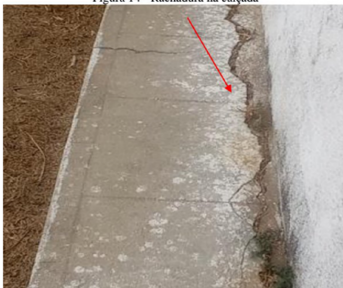
Figura 14 - Rachadura na calçada
