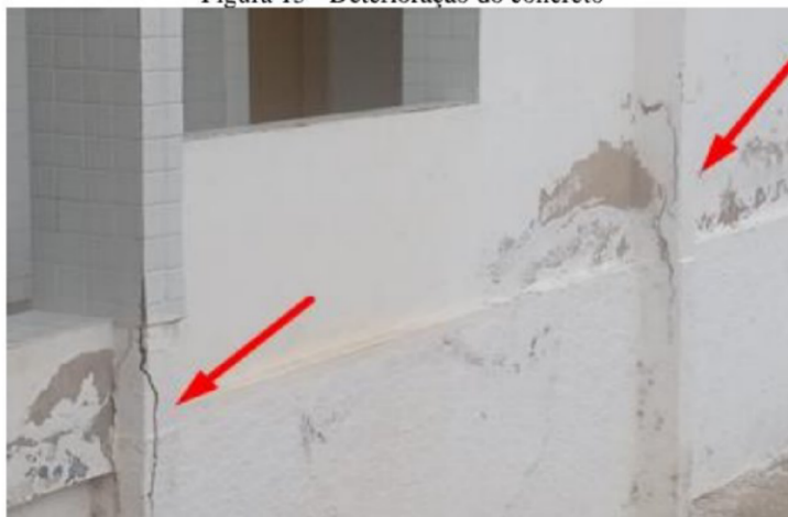
Figura 15 - Deterioração do concreto
