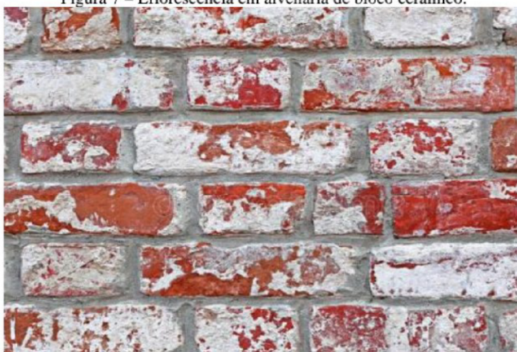
Figura 7 – Eflorescência em alvenaria de bloco cerâmico.
