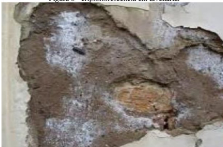
Figura 8 - criptoflorescência em alvenaria.
