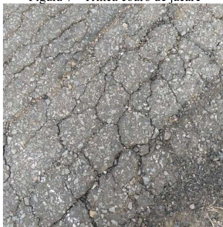
Figura 7 - Trinca couro de jacaré
