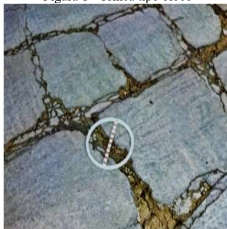
Figura 8 - Trinca tipo bloco
