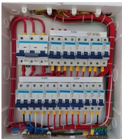
Figura 12 – Exemplo de quadro de distribuição
