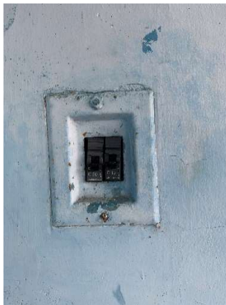
FIGURA 17 – Disjuntor sem identificação do circuito terminal
