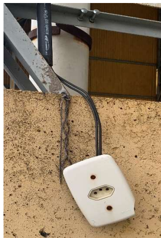
Figura 27 – Tomada deteriorada pela ação do tempo
