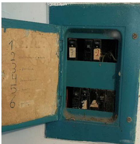
Figura 24 – Quadro de Distribuição sem identificação e visivelmente desgastado
