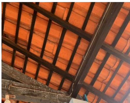
Figura 26 – Condutores instalados na madeira
