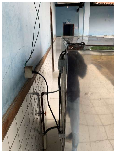
Figura 28 – Instalação Bebedouro I
