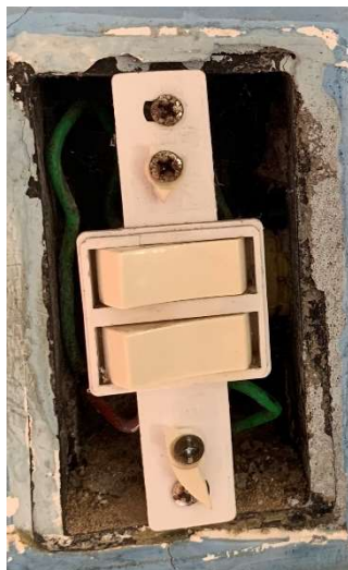
Figura 23 – Interruptor danificado e com condutores expostos
