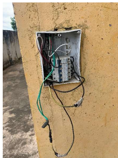
Figura 25 – Quadro de Distribuição Quadra totalmente exposto
