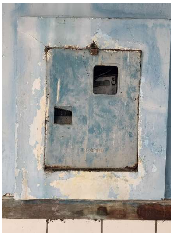
Figura 15 – Quadro de Medição
