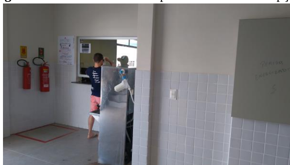
Figura 29 – Saliência em L da parede do hall de recepção.
