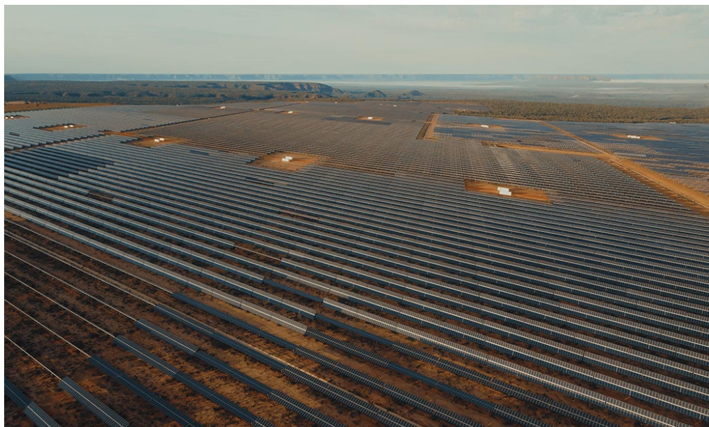
Figura 4: Parque solar são gonçalo - Piauí.
