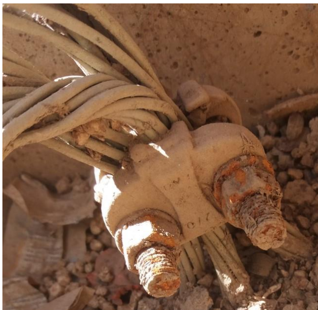
Figura 29: Haste de Aterramento com Conexões enferrujadas.
