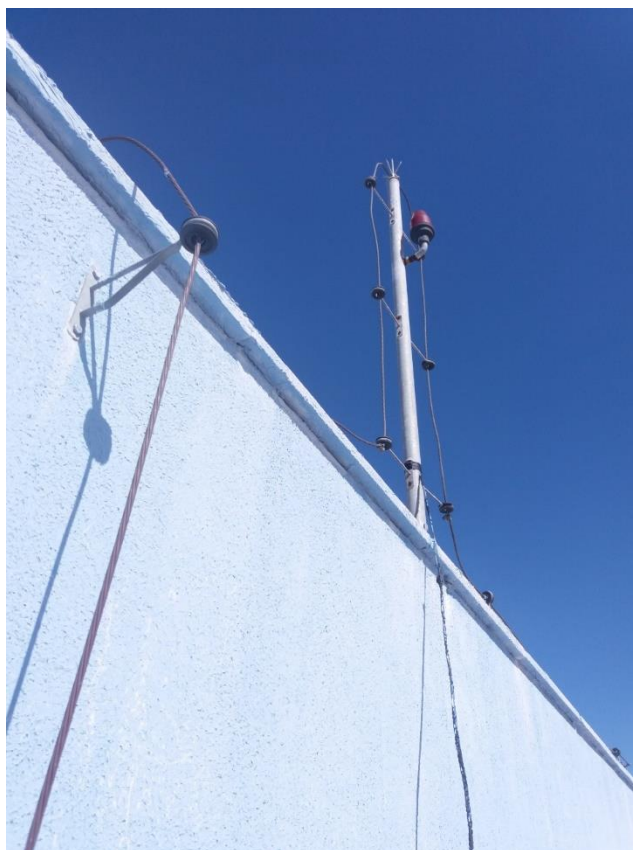
Figura 32: Mini Captor Instalado na Edificação.
