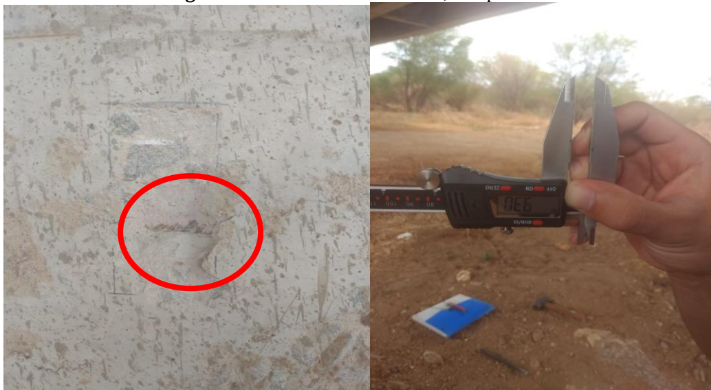
Figura 23: Cobrimento deficiente, de aproximadamente 1 cm.
