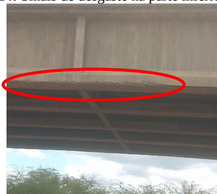
Figura 24: Sinais de desgaste na parte inferior da viga.
