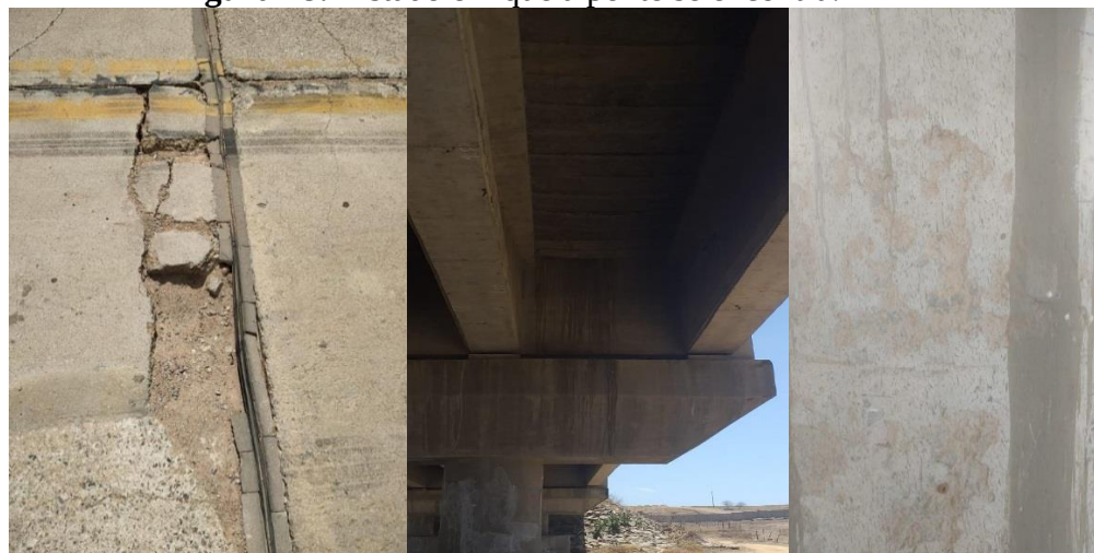
Figura 18: Estado em que a ponte se encontra.
