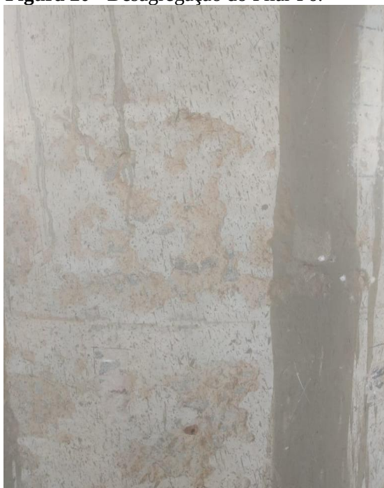
Figura 20 - Desagregação do Pilar P6.
