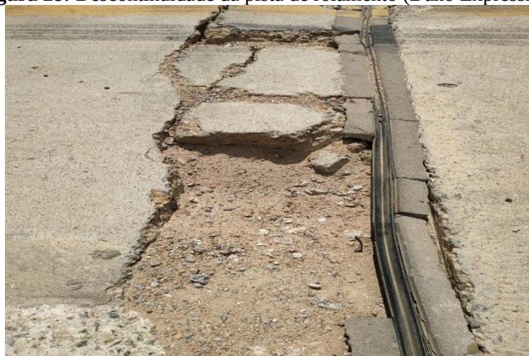
Figura 28: Descontinuidade da pista de rolamento (Dano Expressivo).
