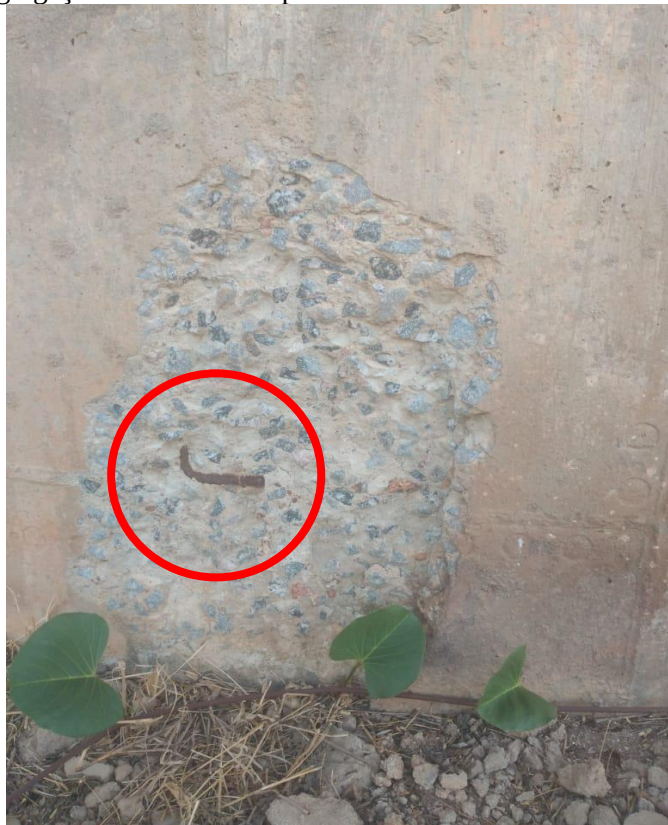
Figura 19: Desagregação do concreto expondo a armadura do bloco de coroamento.
