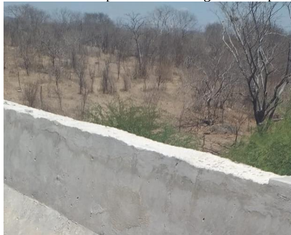
Figura 25: Sinais de desprendimento no guarda-corpos.
