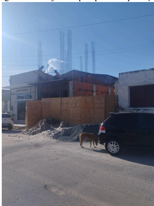
Figura 12 – Laje sem parapeito ou proteção.
