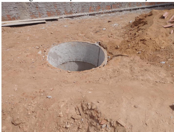
Figura 18 – Poços abertos sem sinalização
