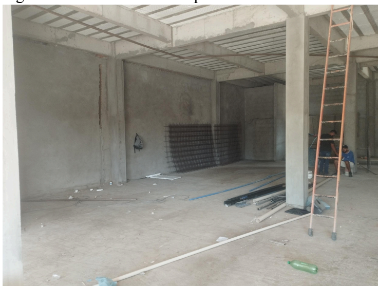
Figura 9 – Escada de mão improvisada e sem estabilidade
