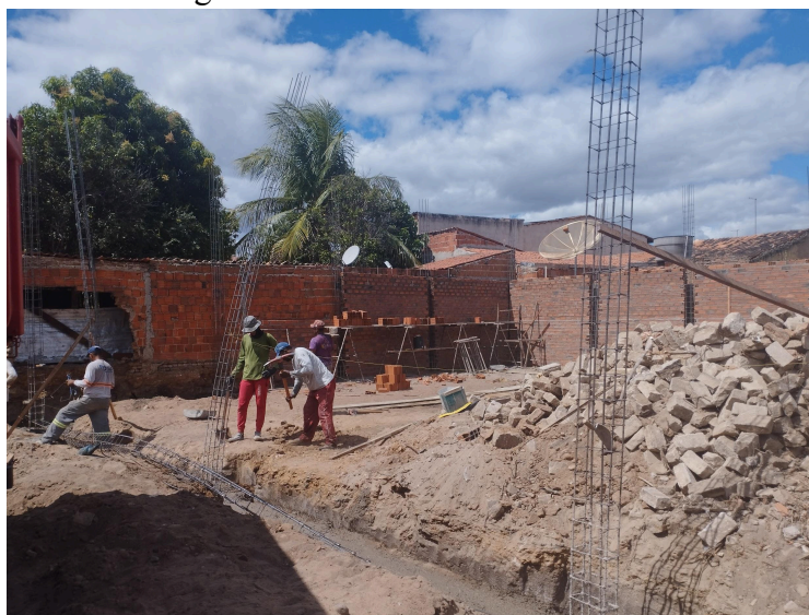
Figura 10 – Trabalhadores sem EPI
