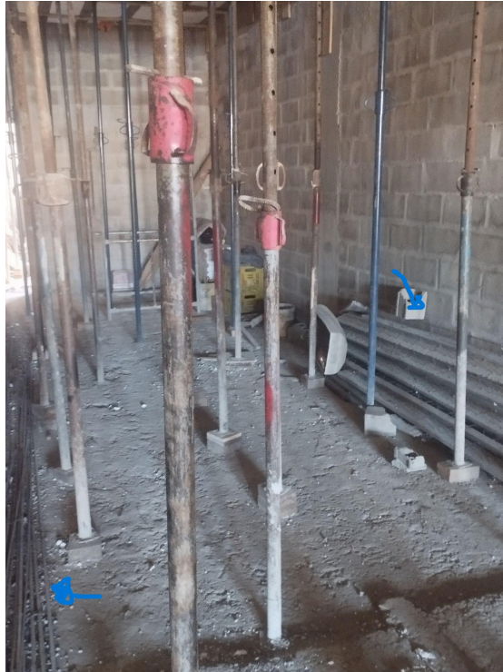
Figura 15 – Vergalhões e materiais no chão
