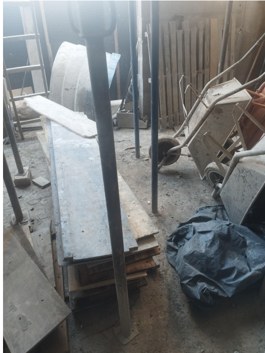
Figura 17 – Materiais mal armazenados
