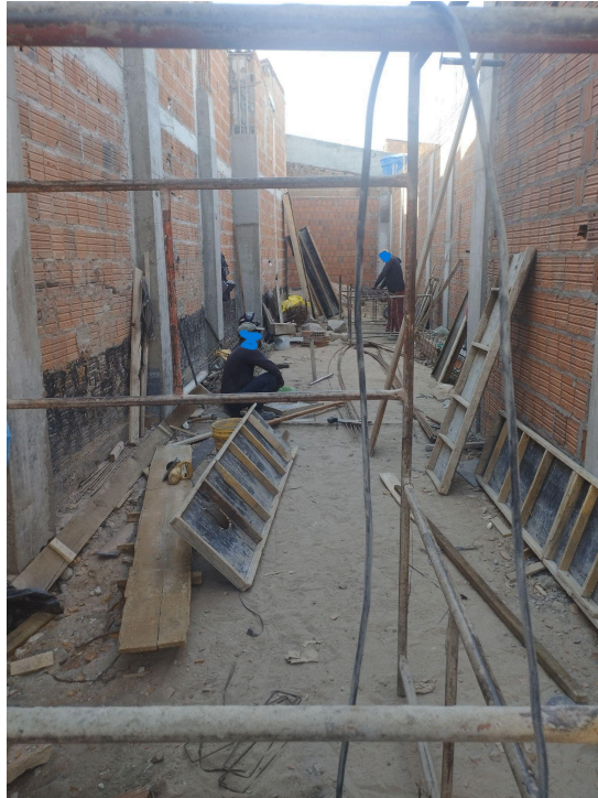
Figura 14 – Trabalhadores sem EPI
