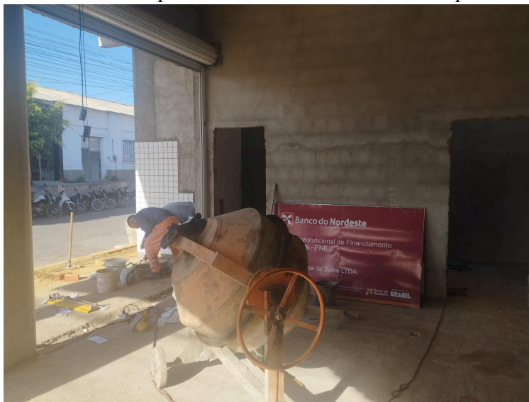
Figura 8 – Trabalhador operando betoneira sem EPIs adequados na Obra 1
