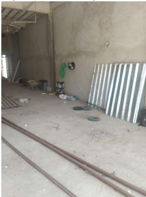
Figura 7 – Desorganização e materiais espalhados no interior da Obra 1
