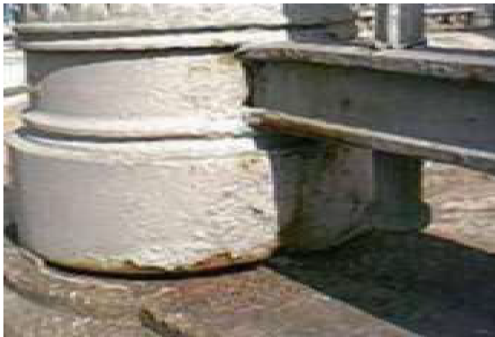
Figura 1: Corrosão eletroquímica devido a exposição atmosférica.
