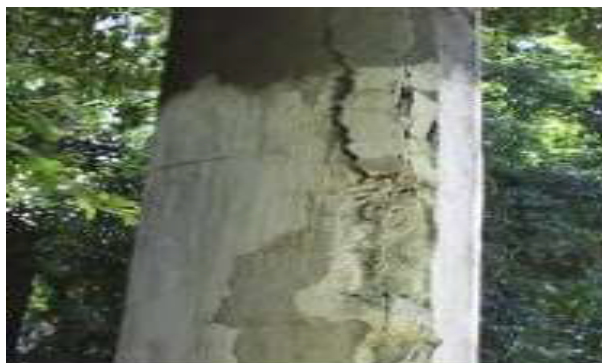
Figura 2: Corrosão química em poste de concreto armado
