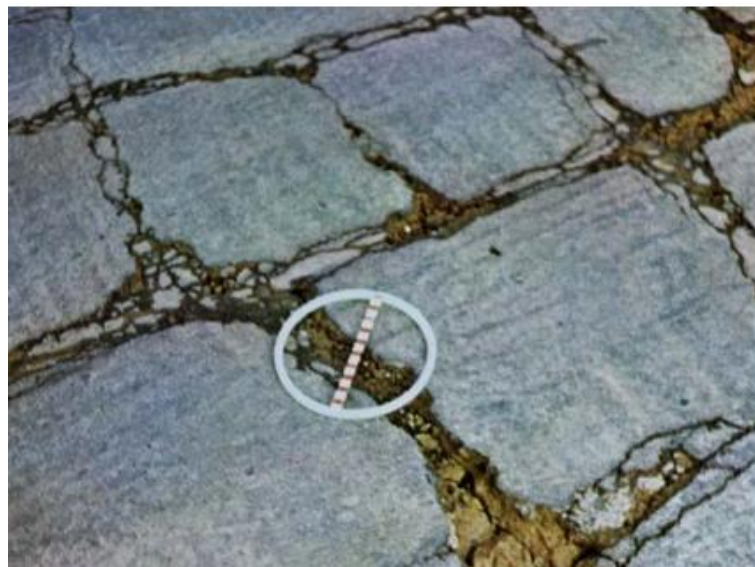
Figura 5 – Trinca interligada do tipo bloco
