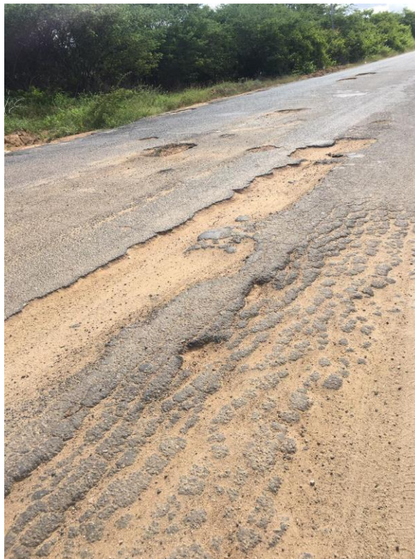
Figura 312 - Panelas e desgaste acentuado
