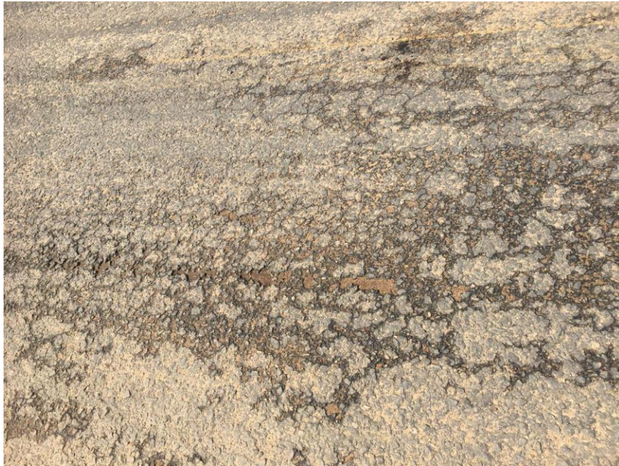
Figura 30 - Trinca interligada do tipo couro de jacaré sem erosão acentuada nas bordas das trincas
