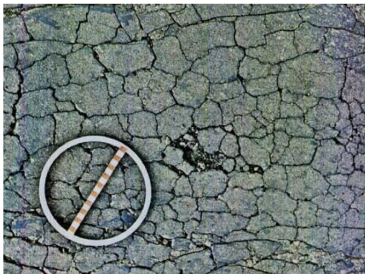
Figura 4 – Trinca interligada do tipo couro de jacaré
