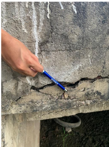
Figura 6 - Fissura horizontal na viga da ponte.
