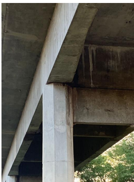
Figura 8 - Presença de eflorescência na viga
