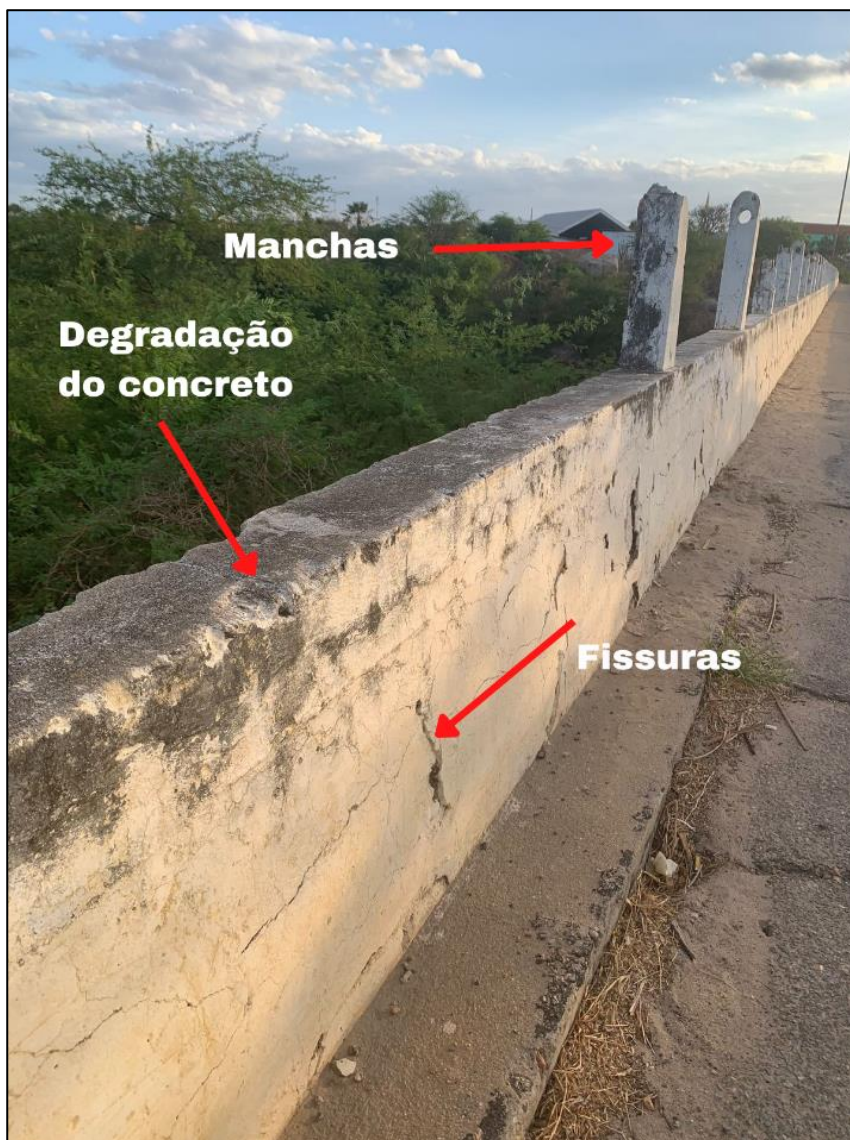
Figura 13 - Guarda-corpo apresentando fissuras, manchas de umidade e degradação do concreto.
