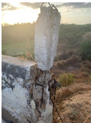
Figura 5 – Armadura corroída em guarda-corpo de concreto armado.
