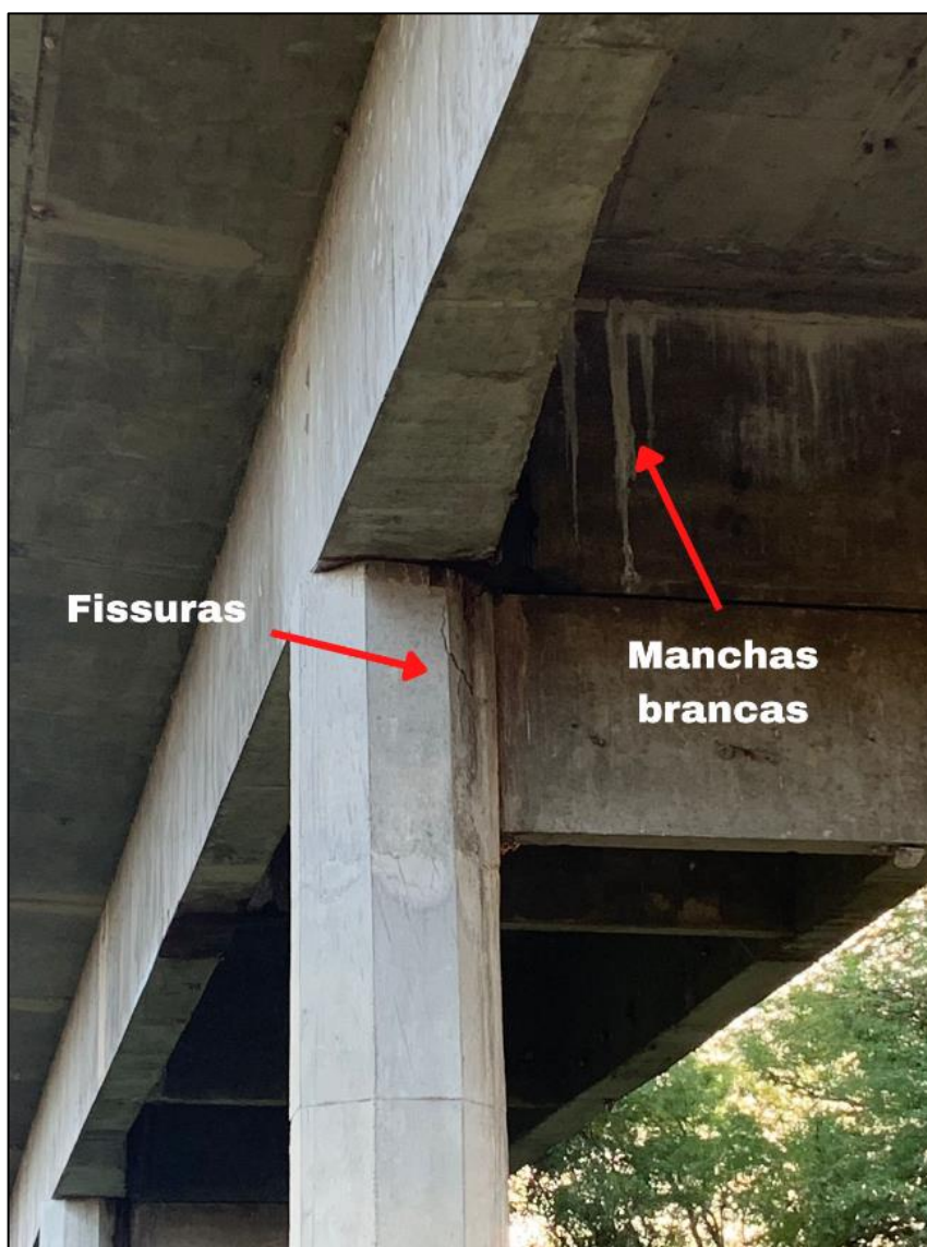
Figura 15 - Infraestrutura e mesoestrutura com presença de manchas e acúmulo de vegetação.
