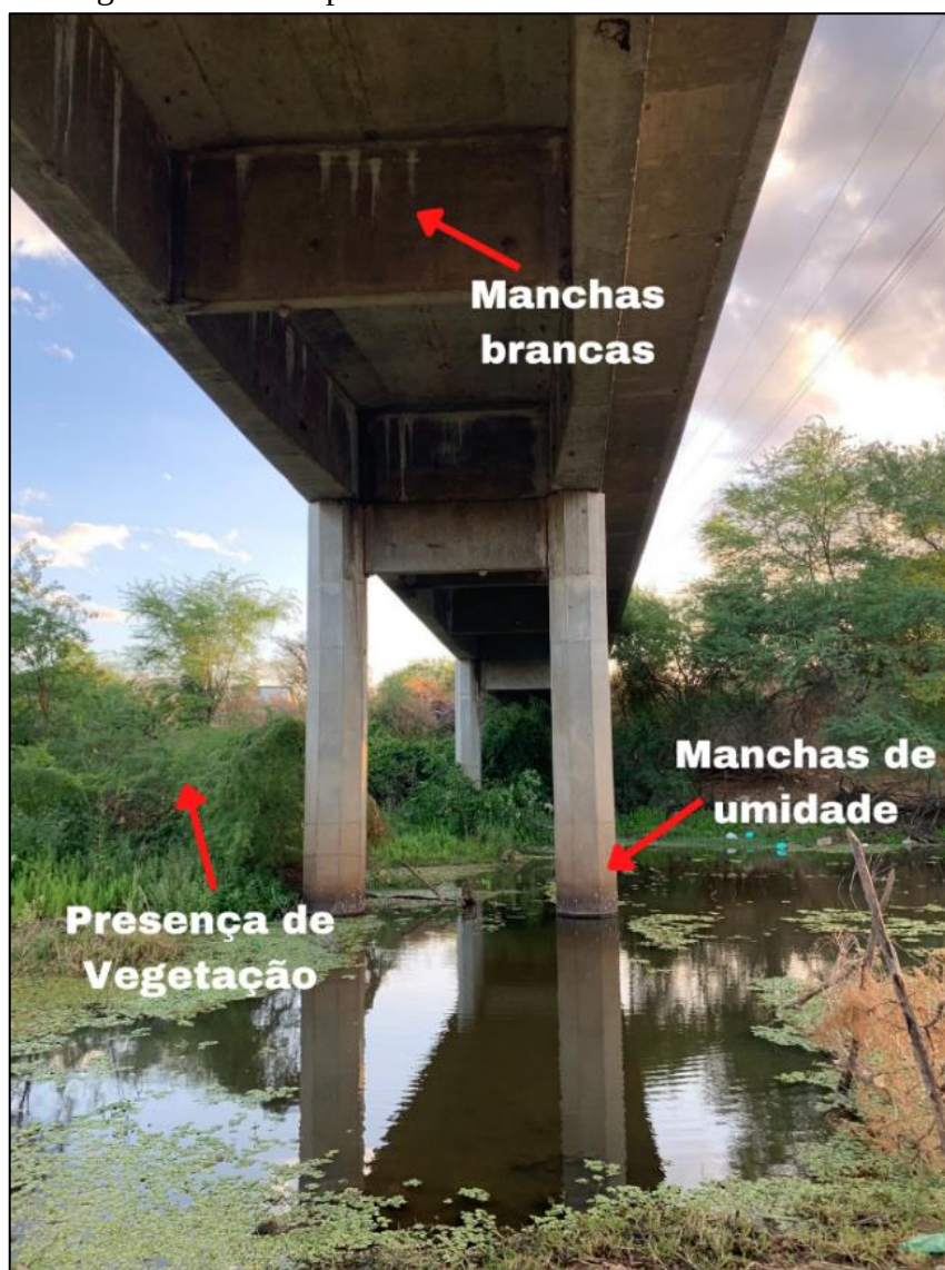
Figura 16 - Pilar apresentando fissuras e manchas brancas.
