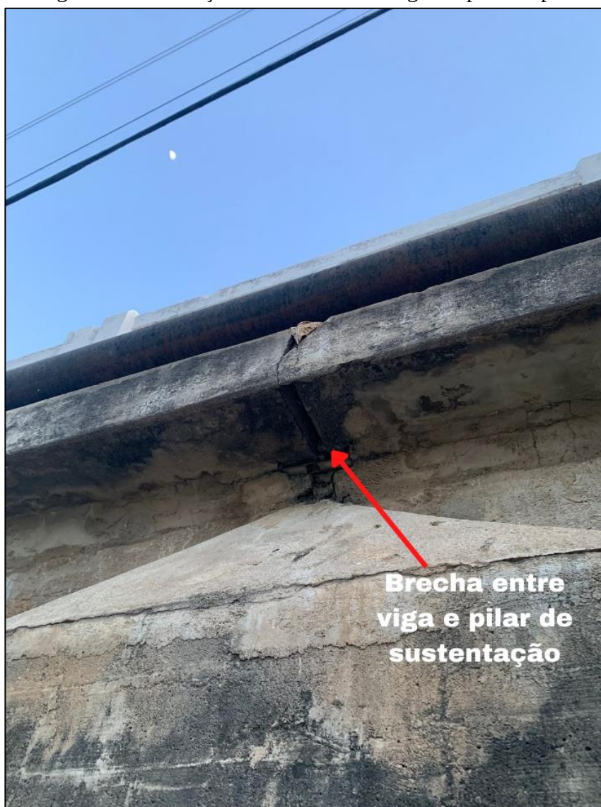
Figura 18 - Presença de brecha entre a viga e o pilar da ponte.
