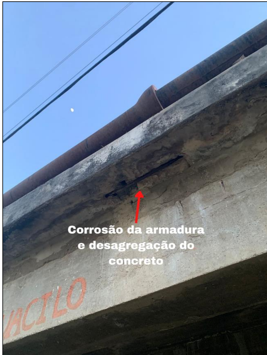
Figura 20 - Corrosão e desagregação do concreto na viga da ponte
