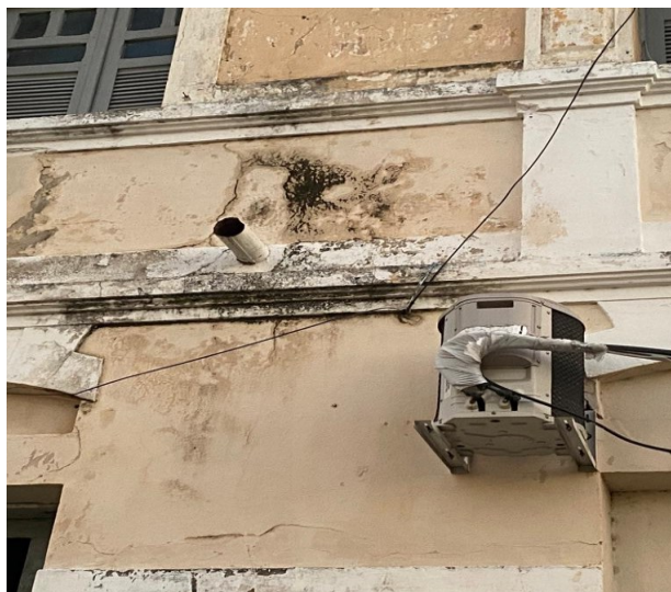
Figura 8 - Trincas e fissuras encontradas no pavimento superior da edificação
