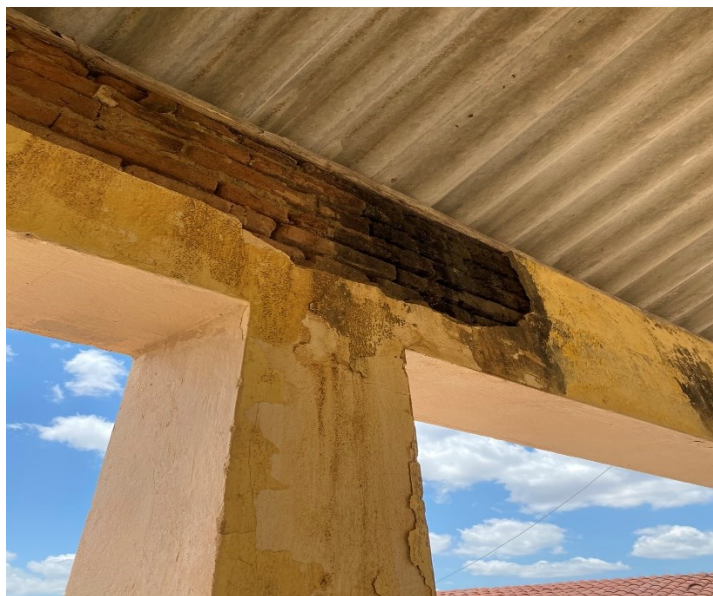
Figura 10 - Área externa da edificação com deslocamento causados por ações físicas
