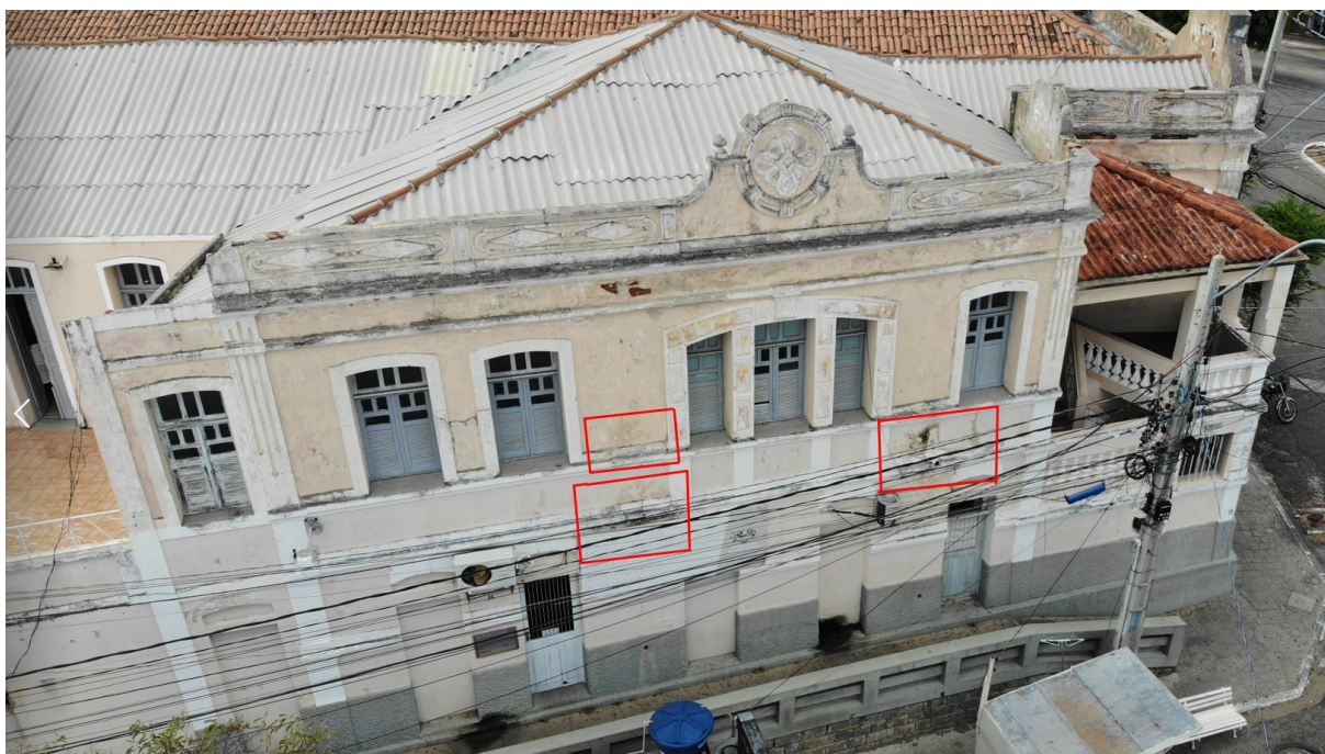
Figura 12 - Sinais de umidade e infiltração na fachada da edificação
