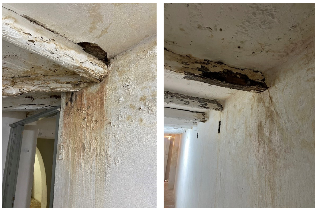
Figura 14 - Manifestações Patológicas em estruturas mistas de madeira e concreto
