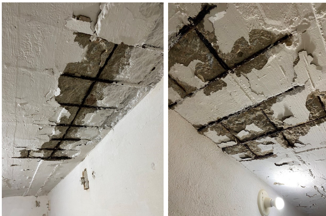
Figura 13 - Corrosão e exposição da armadura
