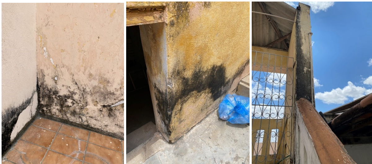
Figura 9 - Manchas ocasionadas pela infiltração da chuva na área
