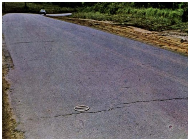
Figura 2: Trinca isolada - Transversal
