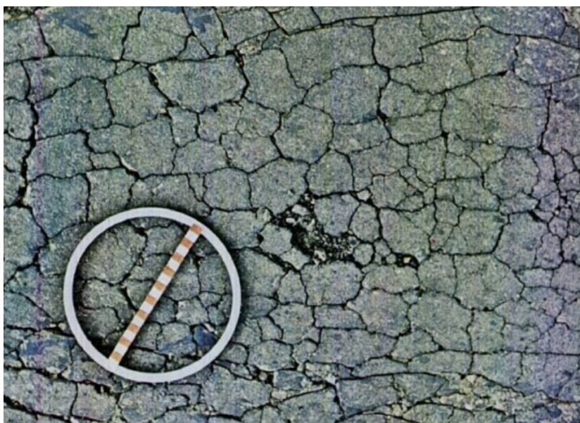
Figura 5: Trinca interligadas - Tipo jacaré
