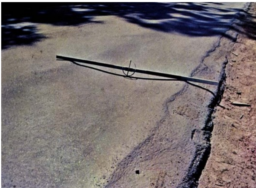
Figura 7 - Afundamento trilha de roda
