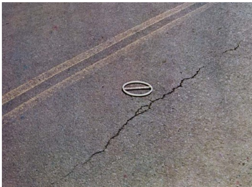
Figura 3: Trinca isolada - Longitudinal
