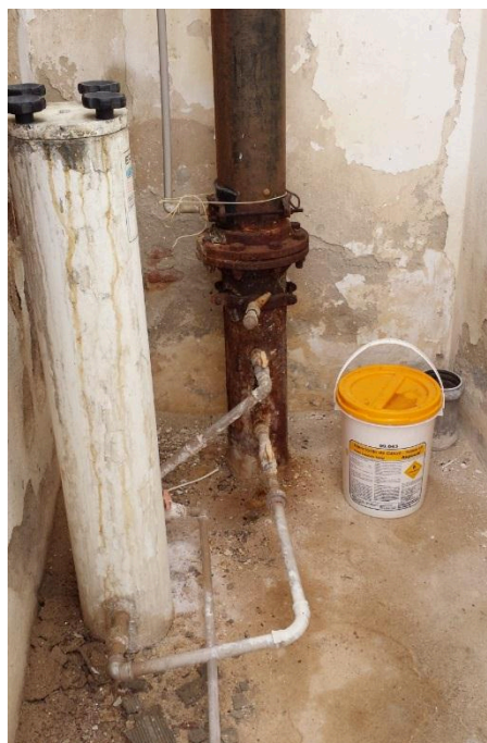
Figura 13 - Local onde é realizado o tratamento da água
