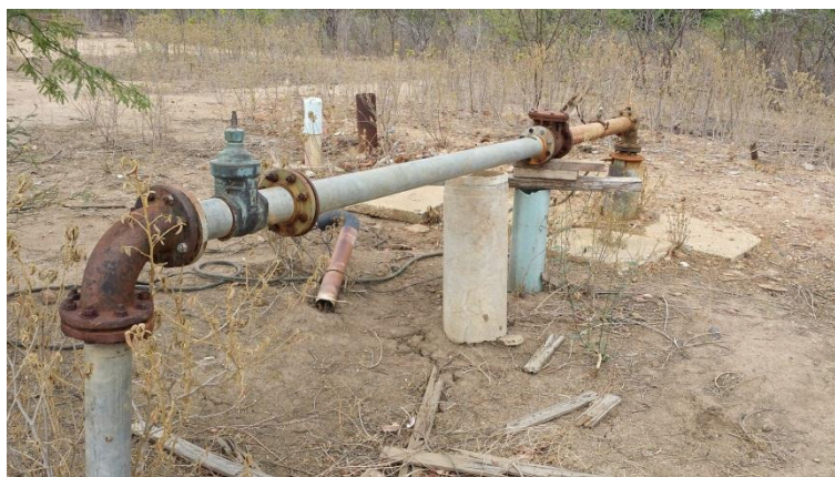
Figura 9 - Instalações do poço tubular na propriedade rural
