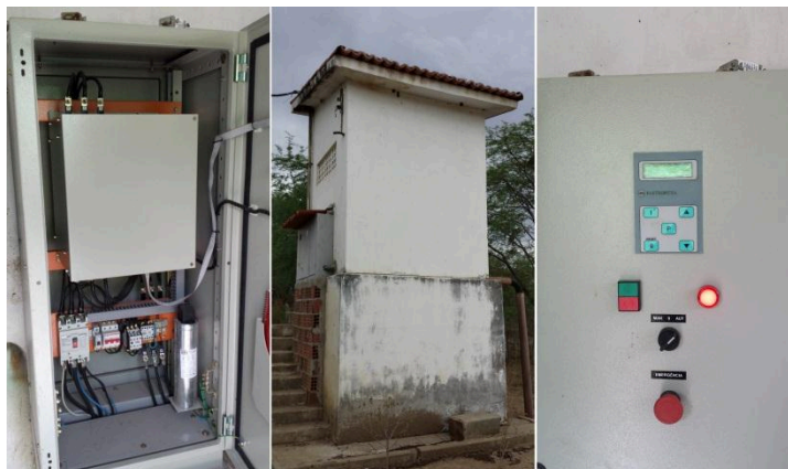
Figura 10 - Casa de força e quadro de comando da bomba
