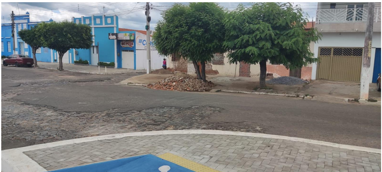
Figura 32 – Acumulo de lixo e entulho nas calçadas do entorno da praça.
