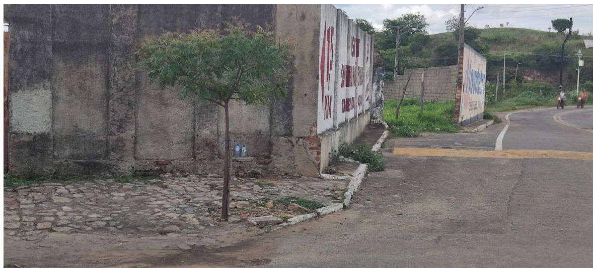
Figura 25 – Calçadas em estado de conservação ruim.
