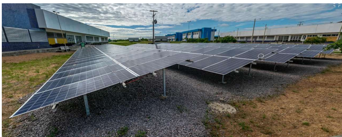
Figura 3 - Usina de energia solar instalada no campus UFERSA Caraúbas
