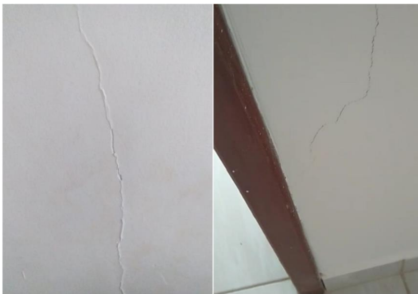
Figura 12 – Fissuras nas paredes da residência
