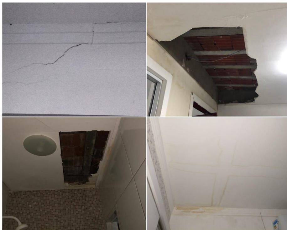
Figura 21 – Trincas, manchas e desprendimento do forro
