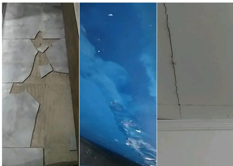
Figura 14 – Desprendimento do material cerâmico, infiltração em parede e trincas no forro
