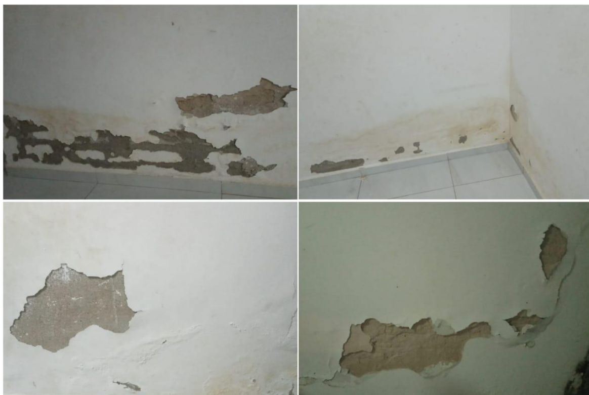
Figura 19 – Eflorescências, manchas e empolamento do revestimento nos ambientes internos das residências
