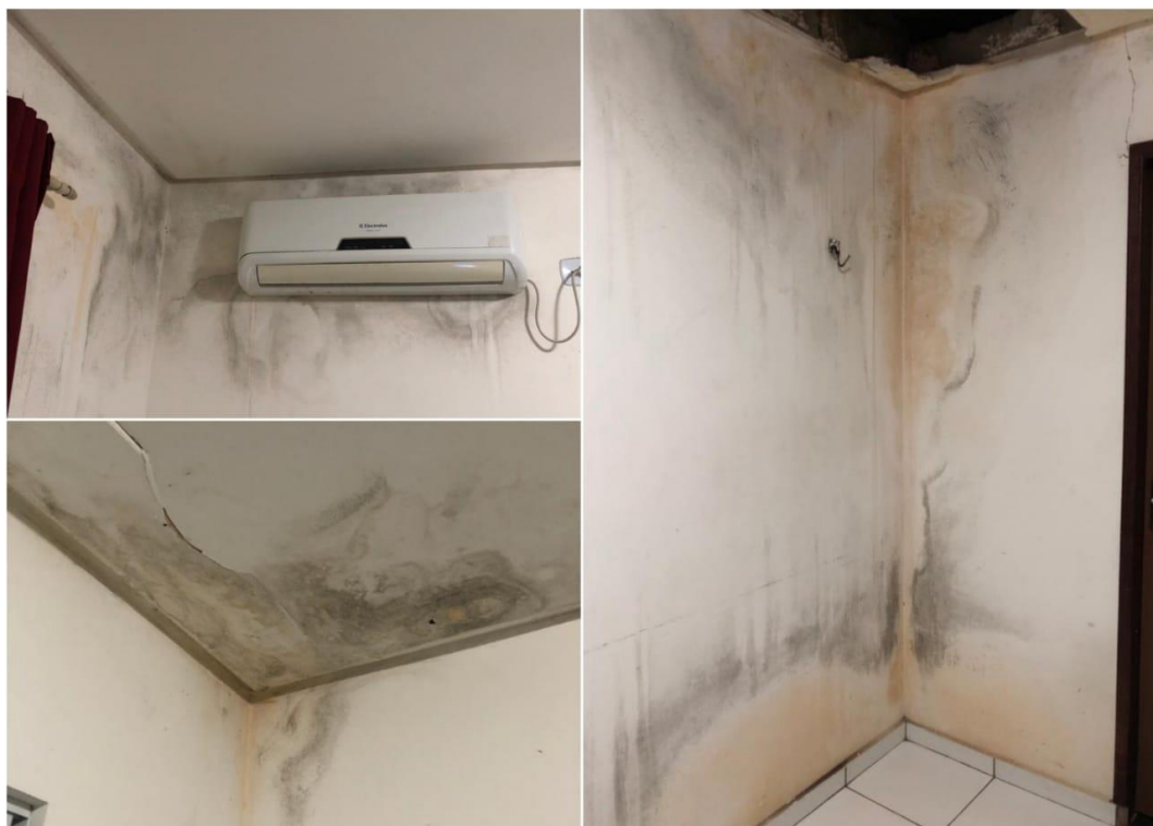
Figura 18 – Proliferação de mofo, manchas nas paredes, trincas no forro e parede e desprendimento de parte do forro
