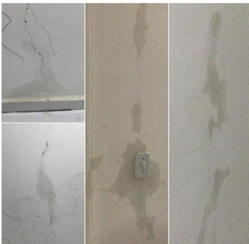
Figura 22 – Infiltrações e fissuras nas paredes internas
