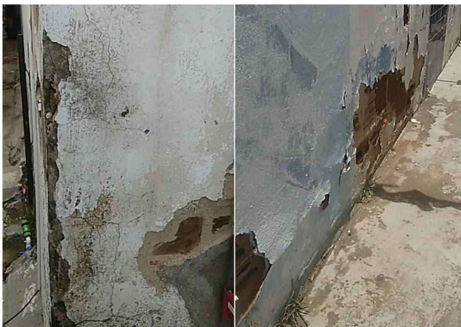
Figura 13 – Fissuras, desprendimento de revestimento, mofo e exposição dos elementos da alvenaria em ambiente externo
