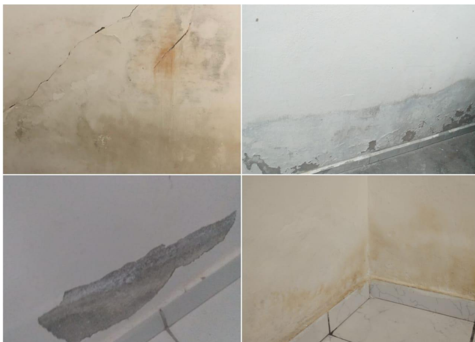
Figura 23 – Manchas, destacamento do revestimento, mofo, fissuras e eflorescência nas paredes internas das residências
