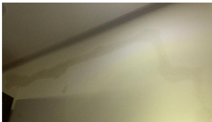
Figura 5 – Infiltração em parede
