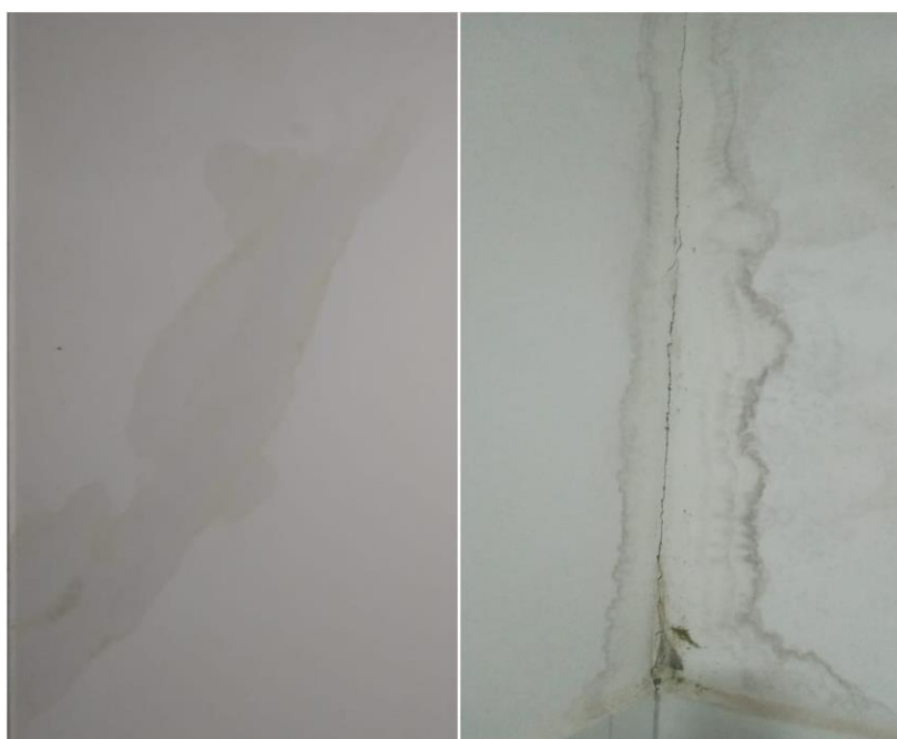
Figura 16 – Infiltrações, manchas nas paredes e fissura
