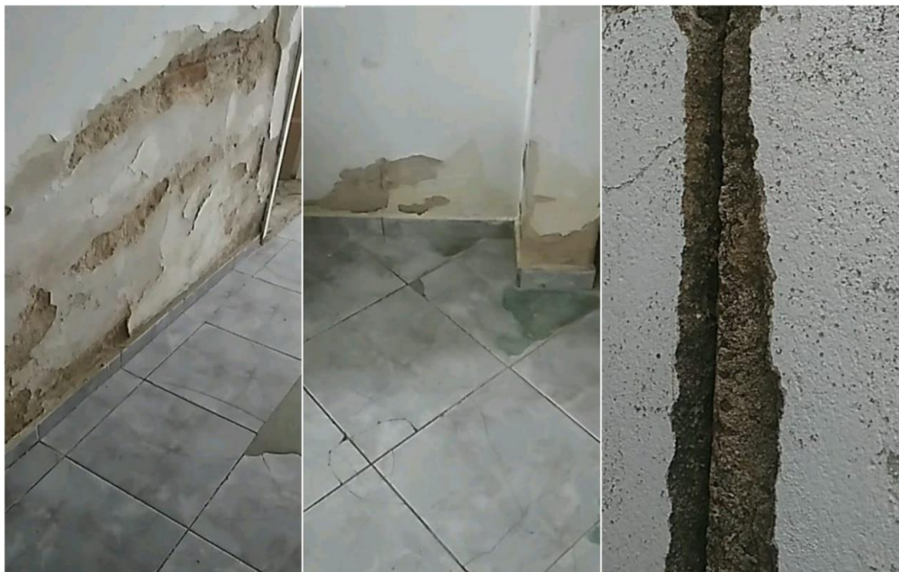
Figura 15 – Eflorescência, manchas na parede e no revestimento cerâmico e rachadura
