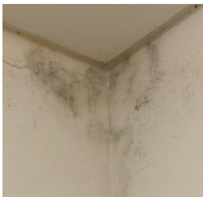
Figura 4 – Aparecimento de manchas e proliferação de fungos
