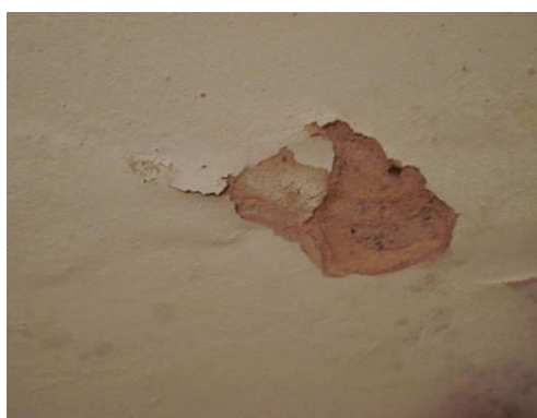
Figura 7 – Descolamento da pintura por ação das subflorescências
