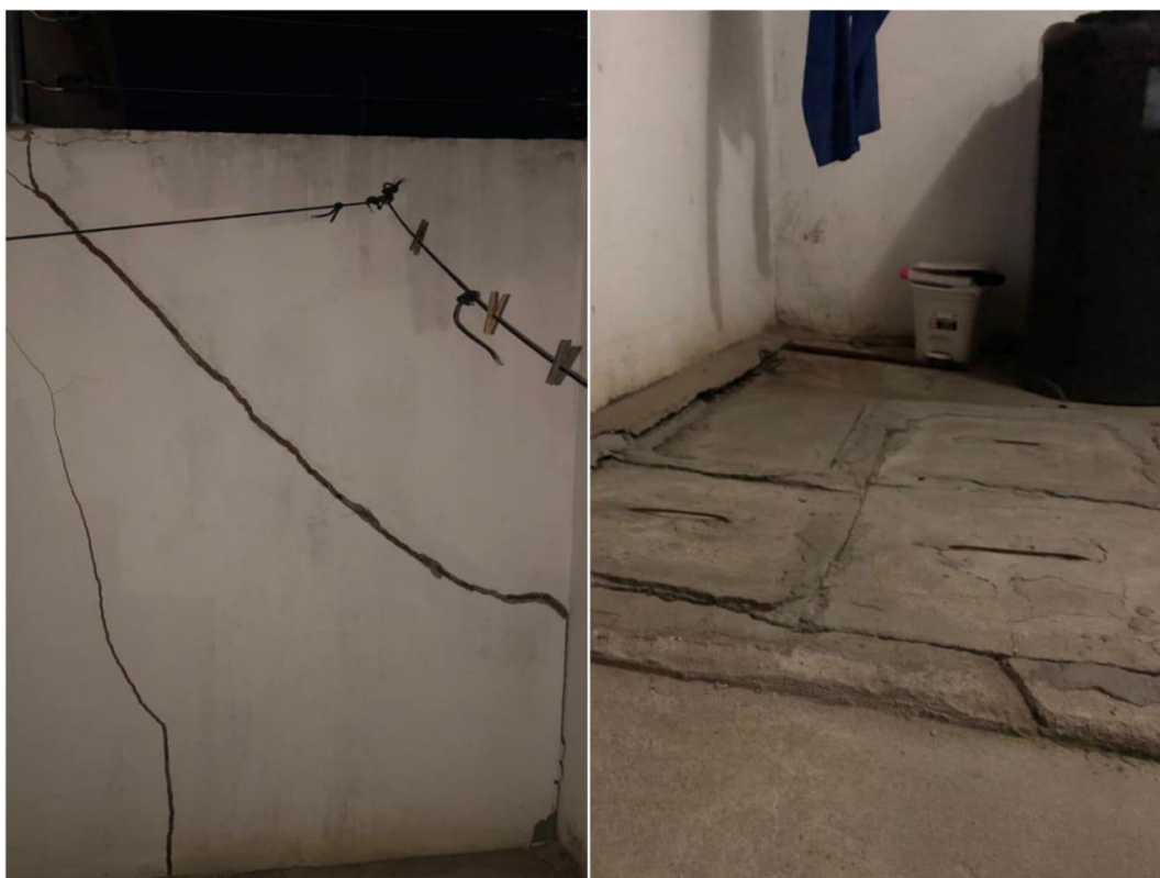
Figura 24 – Rachadura em parede e recalque de piso em ambiente externo
