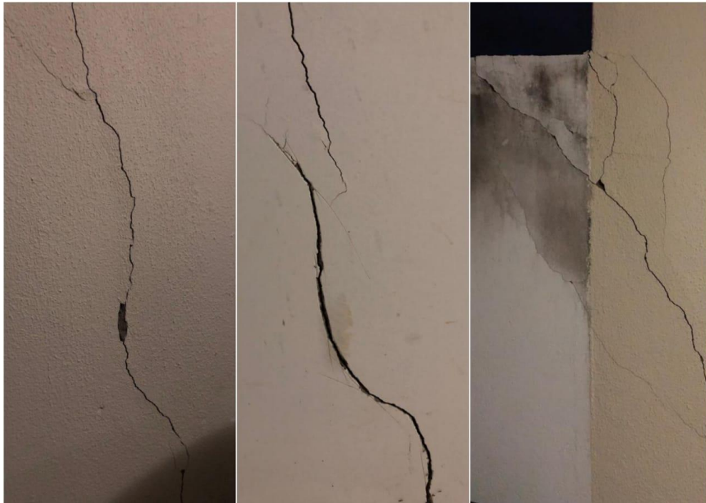
Figura 17 – Trincas em ambiente interno e externo e mofo
