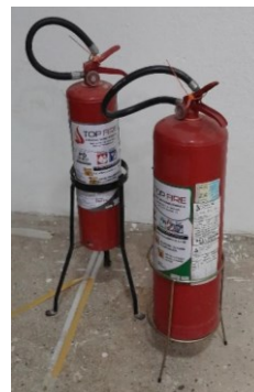
Figura 15. Extintores presentes no local da feira de ciências (Autoria própria, 2025).
