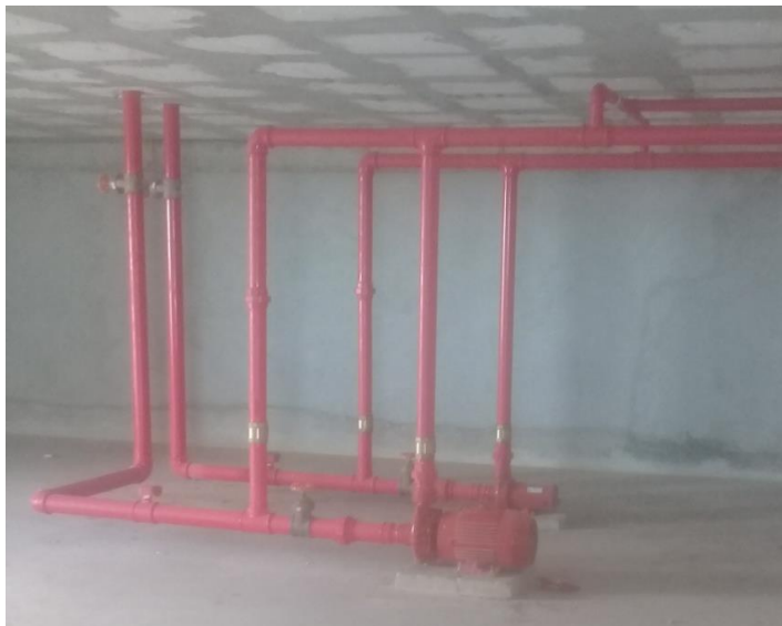
Figura 4 - Casa de bombas instalada em uma obra de construção civil na cidade de Mossoró - RN, 2018.
