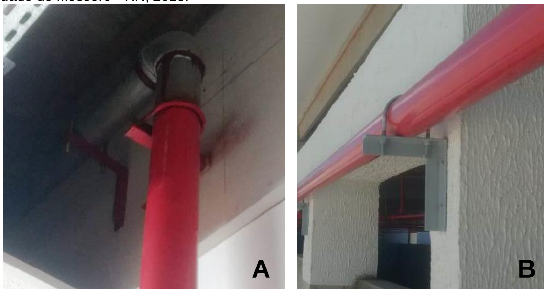
A: Tubulação na cor vermelha; B: Suporte metálico. Fonte: Arquivo pessoal (2018).
