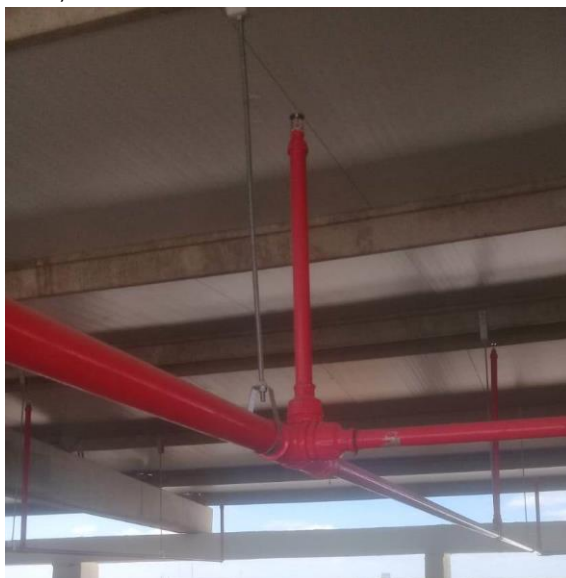
Figura 6 - Sprinkler voltado para cima instalado em uma obra de construção civil na cidade de Mossoró - RN, 2018.
