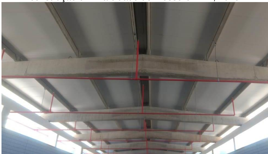
Figura 5 - Sistema de chuveiro automático instalado em uma obra de construção civil na cidade de Mossoró - RN, 2018.
