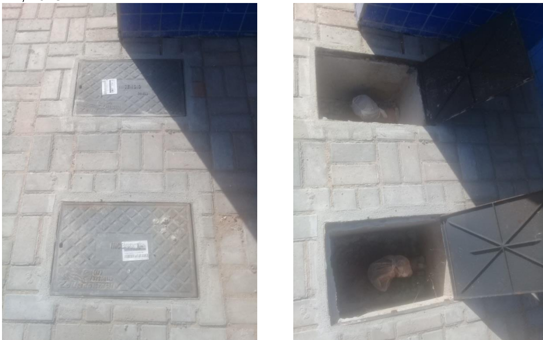
Figura 1 - Hidrante de passeio de uma obra de construção civil na cidade de Mossoró - RN, 2018.
