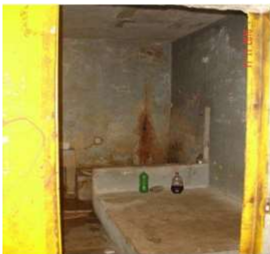
Imagem 05 – Interior de uma das celas disciplinares sem qualquer sistema de ventilação
