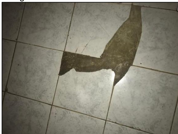
Figura 4 – Deslocamento de cerâmica
