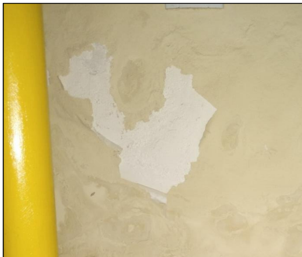
Figura 28 – Descascamento de parede
