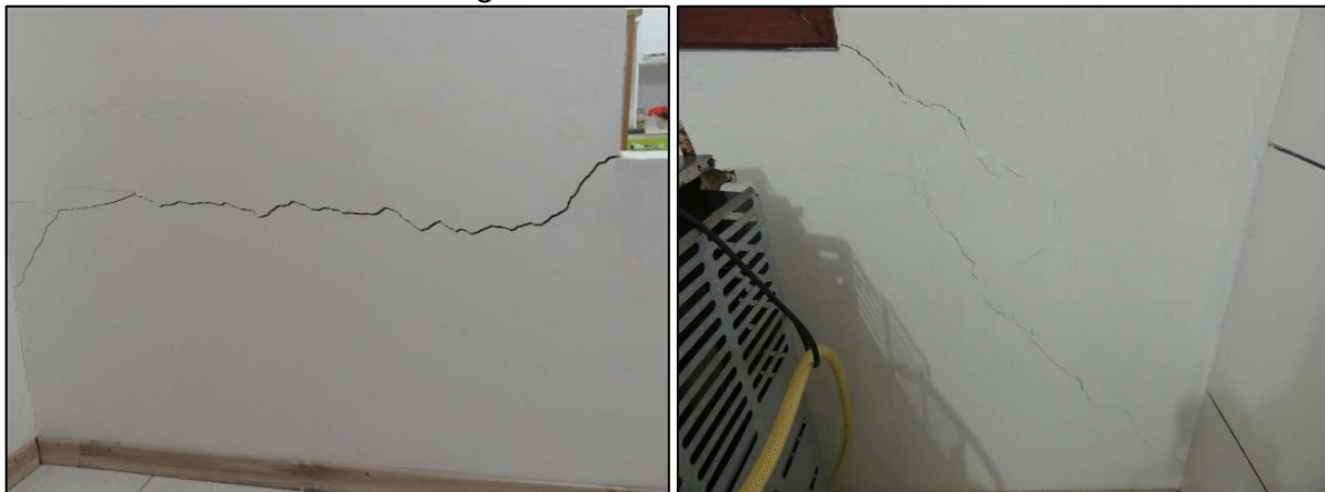
Figura 3 – Trincas e fissuras
