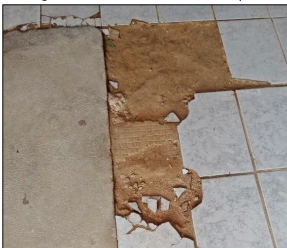
Figura 24 – Deslocamento de piso
