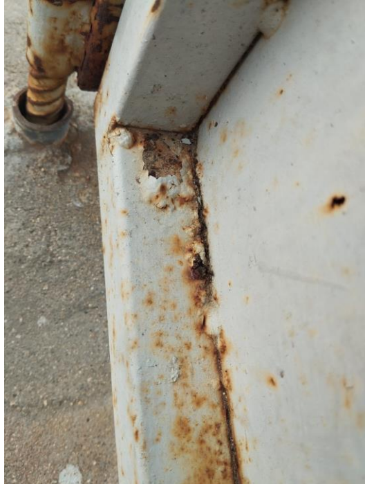
Figura 21 - Corrosão em fresta na base do portão de saída
