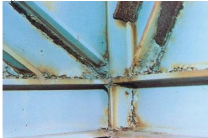
Figura 13 - Processo corrosivo em área com cordões de solda
