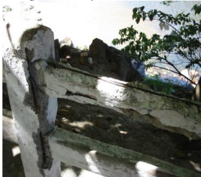
Figura 1 - Corrosão química em concreto armado
