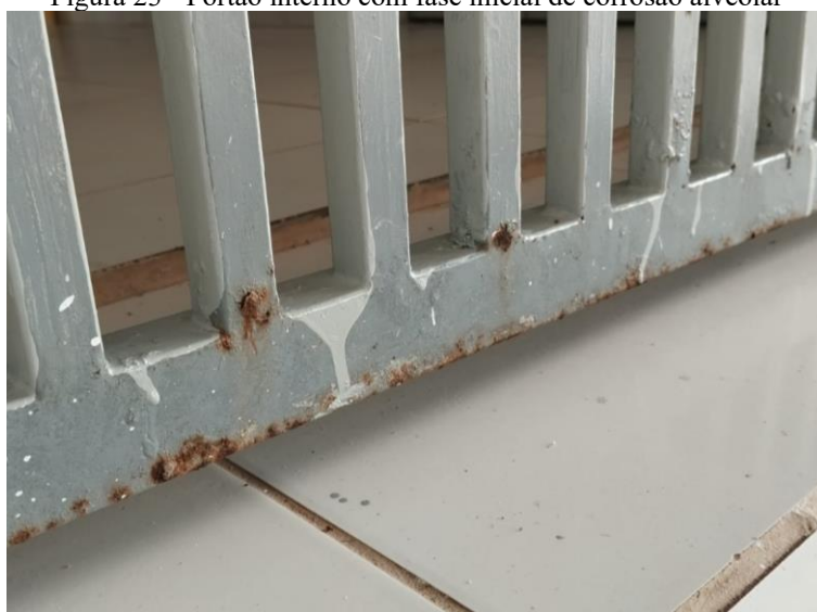
Figura 23 - Portão interno com fase inicial de corrosão alveolar
