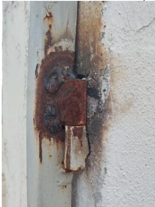
Figura 22 - Corrosão em torno do cordão de solda na dobradiça do portão de saída
