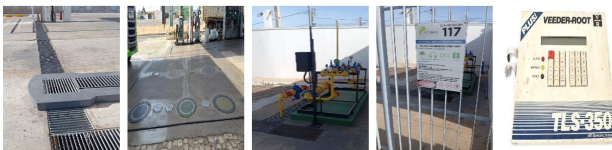
Figura 04 – Equipamentos, Sistemas e Sensores de Monitoramento.
