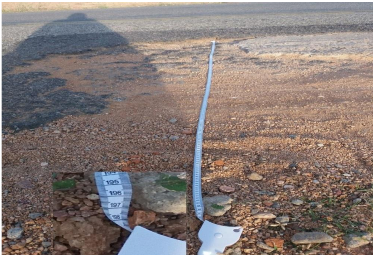
Imagem 2 – Inexistência de acostamento
