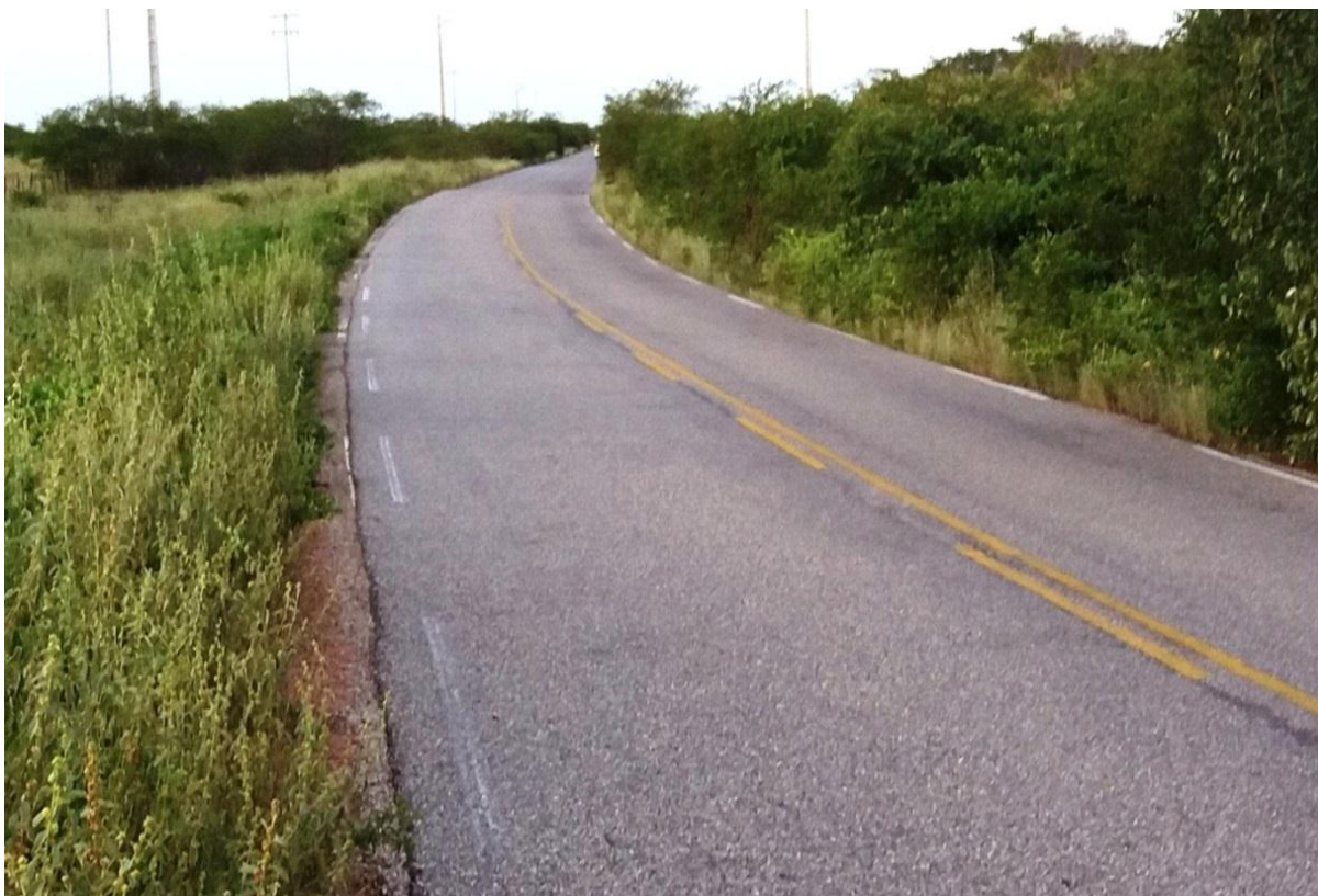
Imagem 3 – Falta de acostamento gerando diminuição de visibilidade na curva
