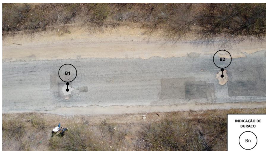
Figura 17 – Processo de catalogação dos buracos do Trecho B
