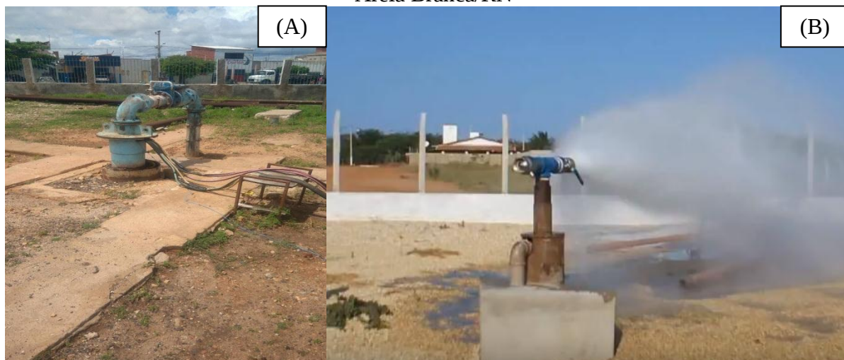
Figura 5- Poço Principal (A) e Poço 2 (B) utilizados para obtenção de água na cidade de Areia Branca/RN
