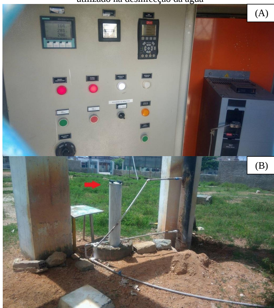
Figura 6 - Painel de comando elétrico controlador da bomba (A) e depósito contendo cloro utilizado na desinfecção da água
