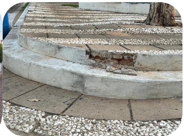
Figura 15 - Praça da República: Ausência de Acessibilidade
