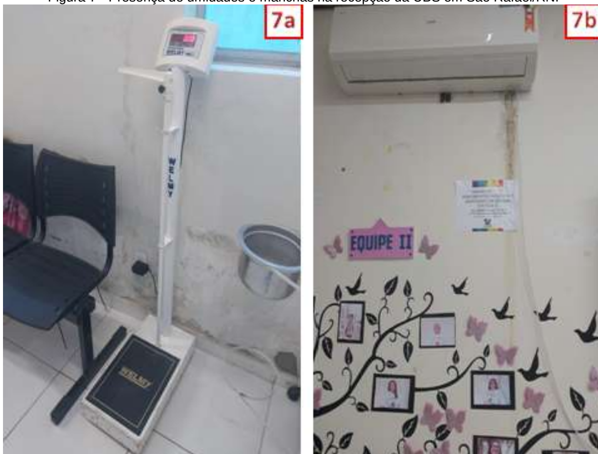
Figura 7 - Presença de umidades e manchas na recepção da UBS em São Rafael/RN.
