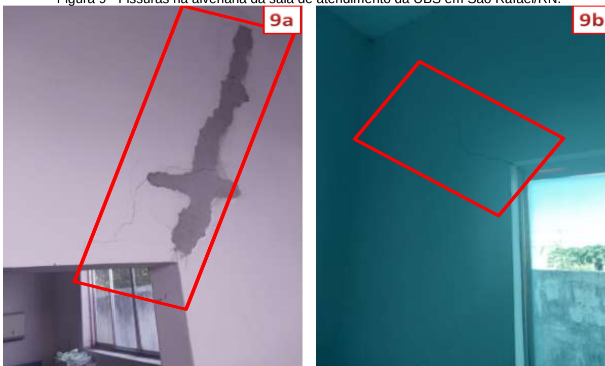
Figura 9 - Fissuras na alvenaria da sala de atendimento da UBS em São Rafael/RN.
