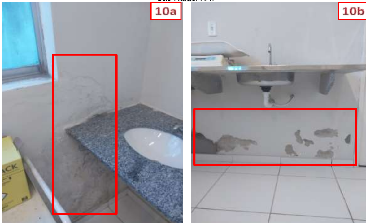
Figura 10 – Umidade, mofo e deslocamento do revestimento da sala de atendimento da UBS em São Rafael/RN.
