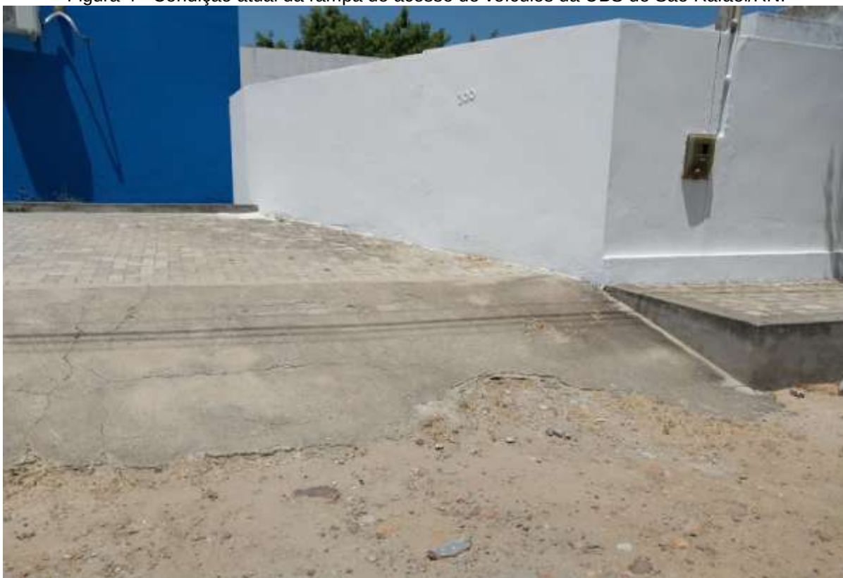
Figura 4 - Condição atual da rampa de acesso de veículos da UBS de São Rafael/RN.
