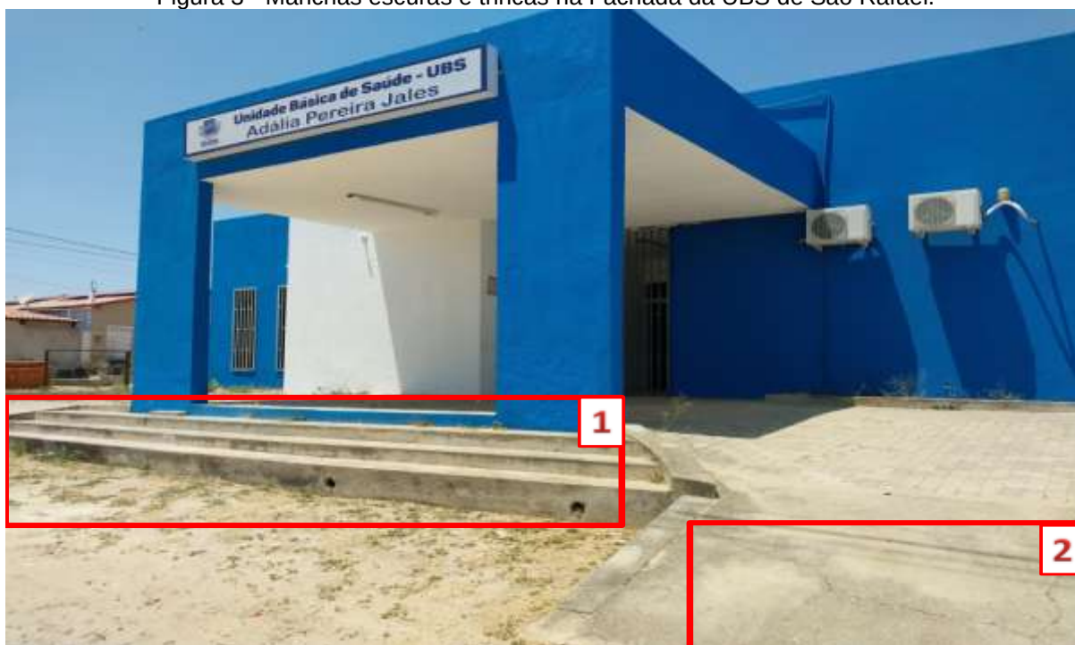
Figura 3 - Manchas escuras e trincas na Fachada da UBS de São Rafael.
