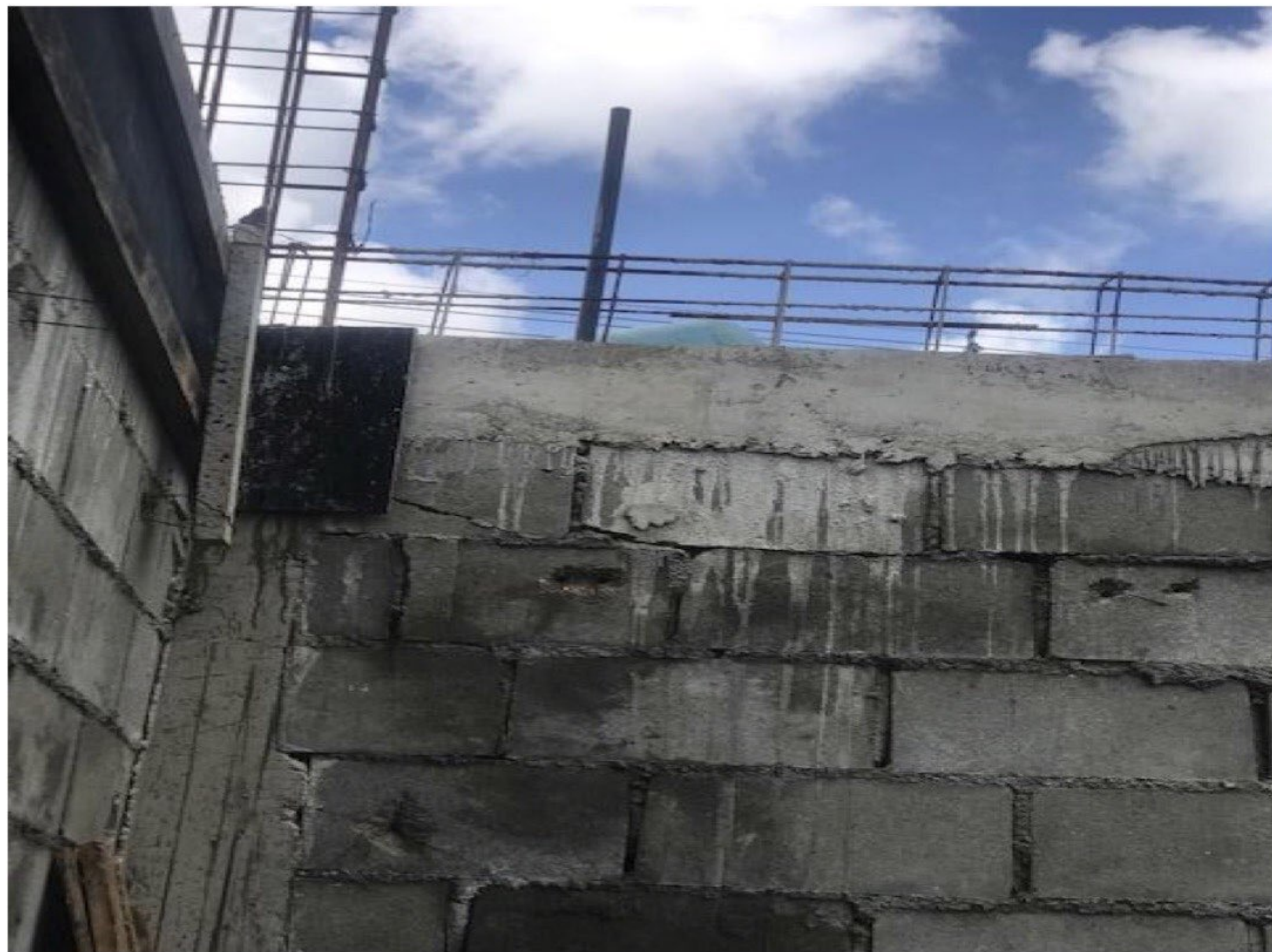
Figura 33 - Eletroduto embutido na alvenaria
