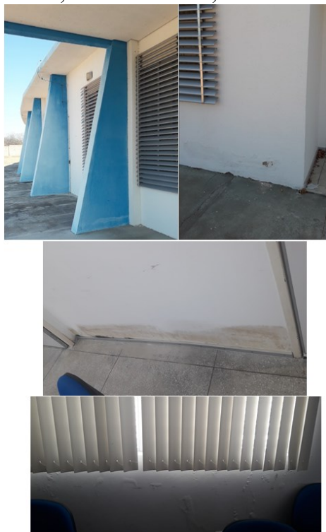
Figura 33 - Perda de cor, Descascamento, Manchas e Bolhas em Paredes
