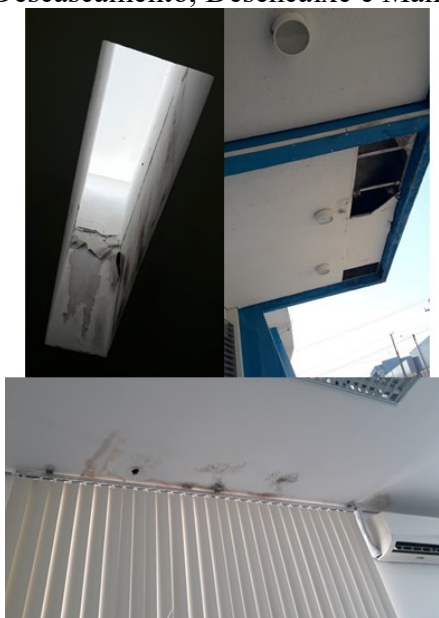
Figura 35 - Descascamento, Desencaixe e Manchas em forro
