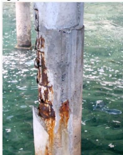
Figura 8 - Desagregação do concreto e corrosão das armaduras
