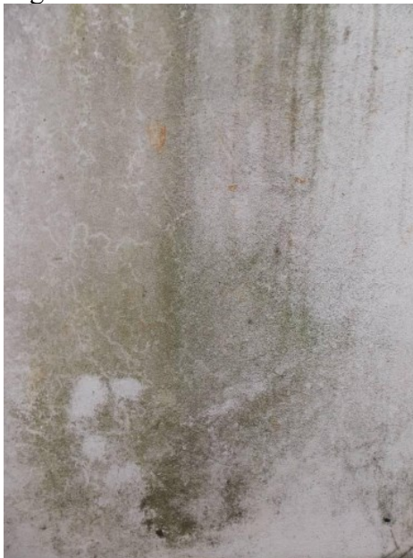
Figura 7 - Mofo/Bolor em alvenaria
