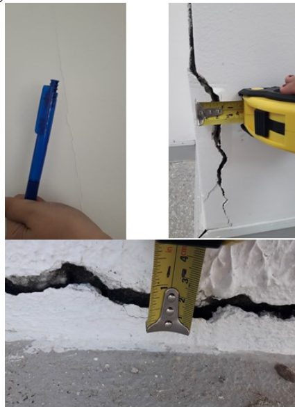
Figura 32 - Fissura e Fendas em Paredes
