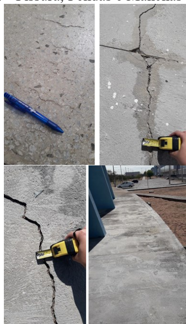
Figura 34 - Fissura, Fendas e Manchas em Pisos -
