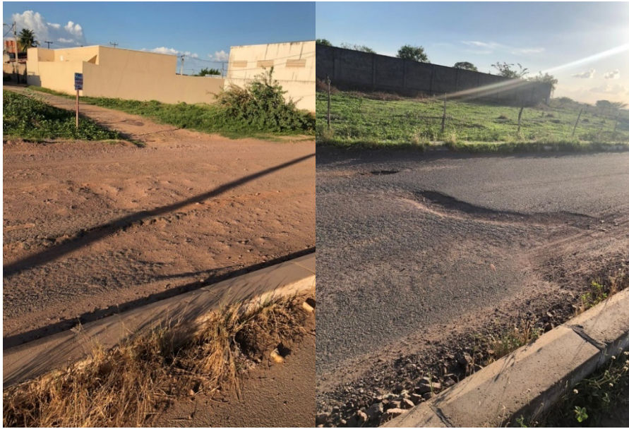
Figura 12 – Patologias Estruturais Presentes na Via
