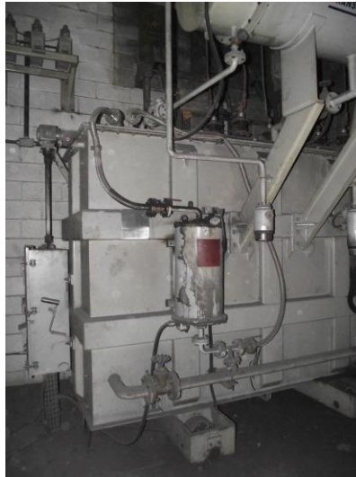
Figura 5: Transformador de um forno elétrico
