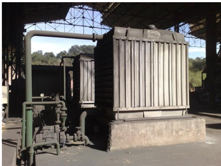
Figura 4: Torre de Resfriamento
